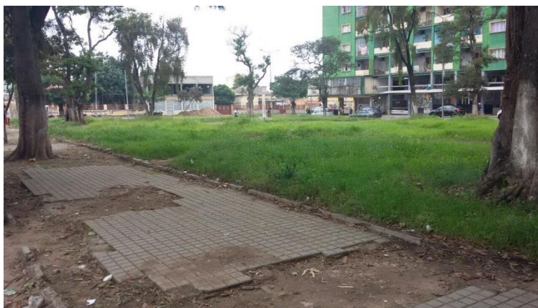
Figura 73 - Estado de degradação do largo Pica Pau na cidade do Huambo, 2016; Fonte: Autor
