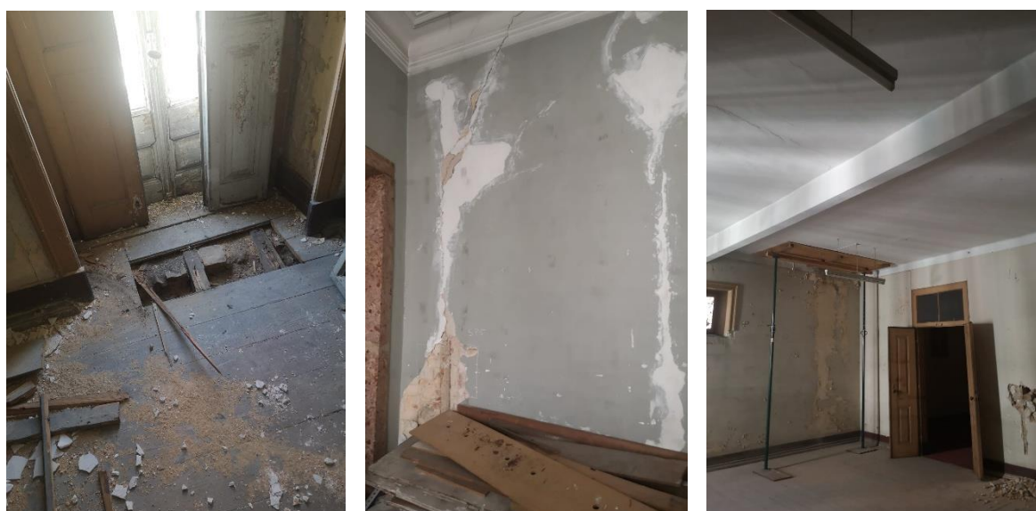
Figura 72 – Imagens do piso 3: pavimento degradado com estrutura de apoio à vista (barrotes), fendilhação na parede do piso 3 e reforço do teto com problemas estruturais (autoria própria, 2023).
