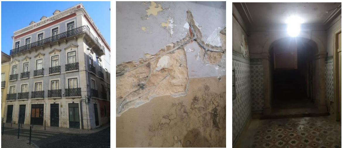
Figura 68 – Imagens da fachada principal virada a poente e do piso térreo, fendilhação na parede da escada do piso térreo e entrada principal (autoria própria, 2023).
