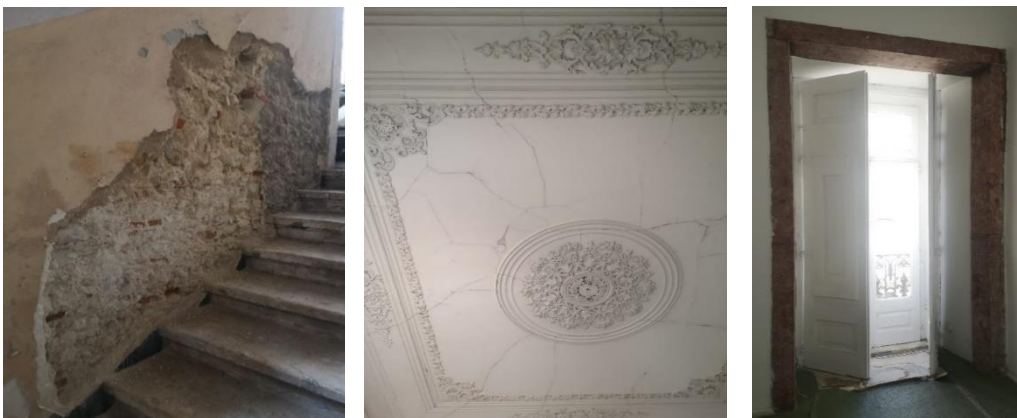
Figura 71 – Imagens do piso 2: parede da escada, teto fendilhado e Janela de sacada com portadas do piso 2 (autoria própria, 2023).
