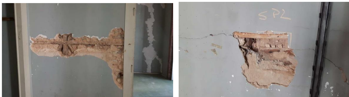
Figura 66 – Piso 2. Sondagem estrutural numa parede de frontal e numa parede de tabique (A2P, 2019).
