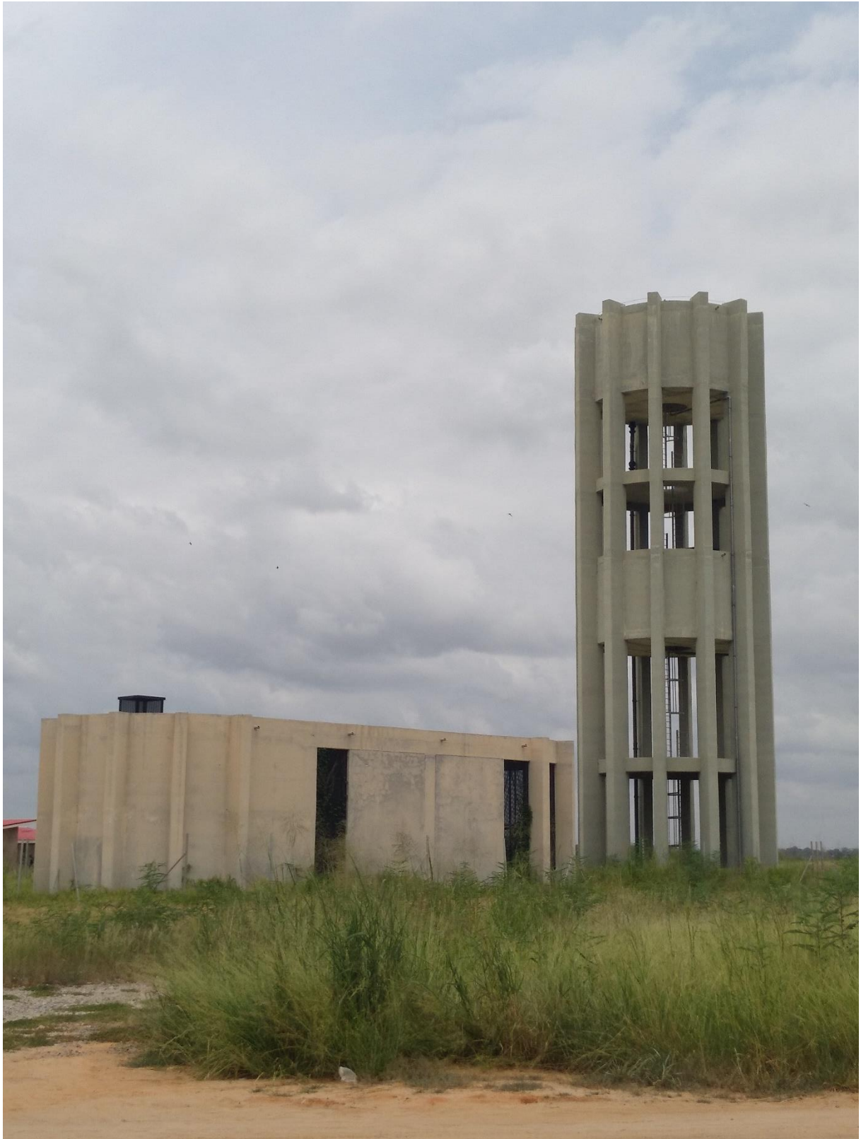
Fotografia 3 – Reservatório de água e casa onde está instalada a maquinaria para tratamento e distribuição da água, ambos em mau estado de conservação e desactivados.
