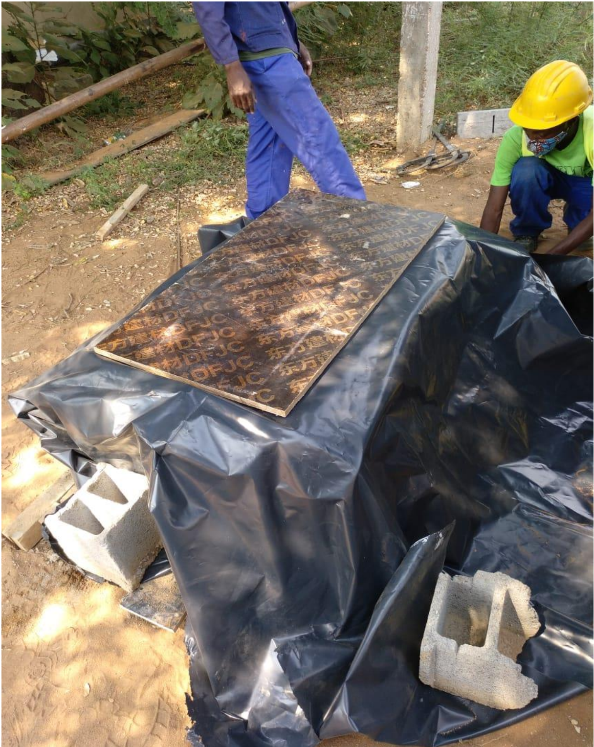
Fotografia 13 – Cobrimento da parede no final do dia de trabalho para evitar a evaporação da água demasiado rápida e consequente fissuração.
