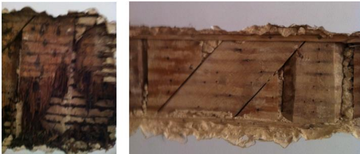
Figura 3.18 – Parede de tabique degradada e parede em bom estado, (imagem do autor, 2019).
