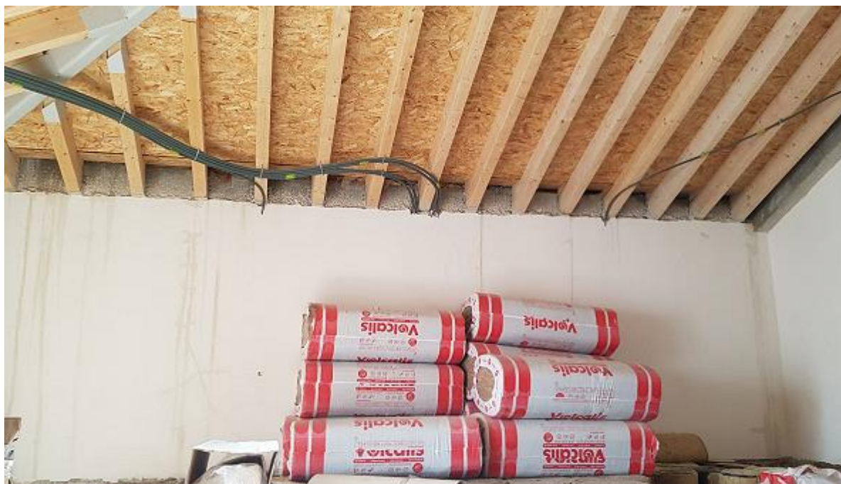
Figura 3.52 - Entrada de água no edifício devido à má execução de caleiras, (imagem do autor, 2019).
