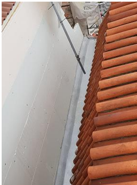
Figura 3.51 - Caleira entre o edifício do Arco e edifício vizinho, (imagem do autor, 2019).
