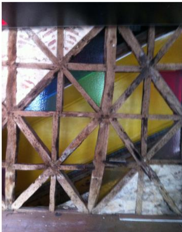
Figura 3.7 - Edifício do Arco do Bandeira, parede de frontal sem alvenaria no Piso 4, (imagem do autor, 2019).
