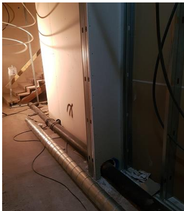
Figura 3.56 - Infraestruturas de águas residuais e AVAC no piso 1, (imagem do autor, 2019).
