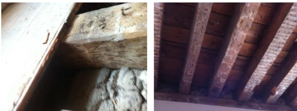
Figura 3.19 - Vigas de pavimento com sinais de ataque de xilófagos, (imagem do autor, 2019).
