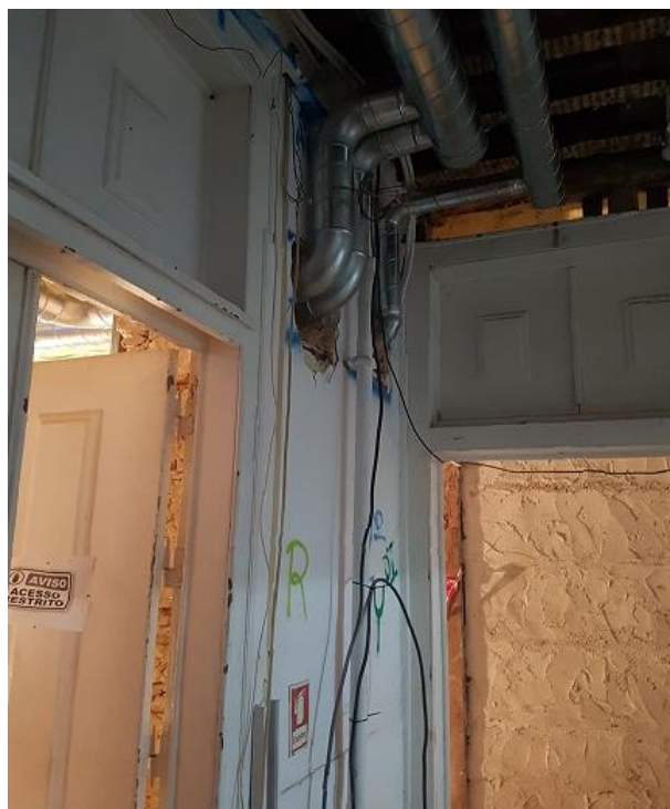
Figura 3.54 - Atravessamento de condutas de AVAC entre "prédio 1" e "prédio 2", (imagem do autor, 2019).
