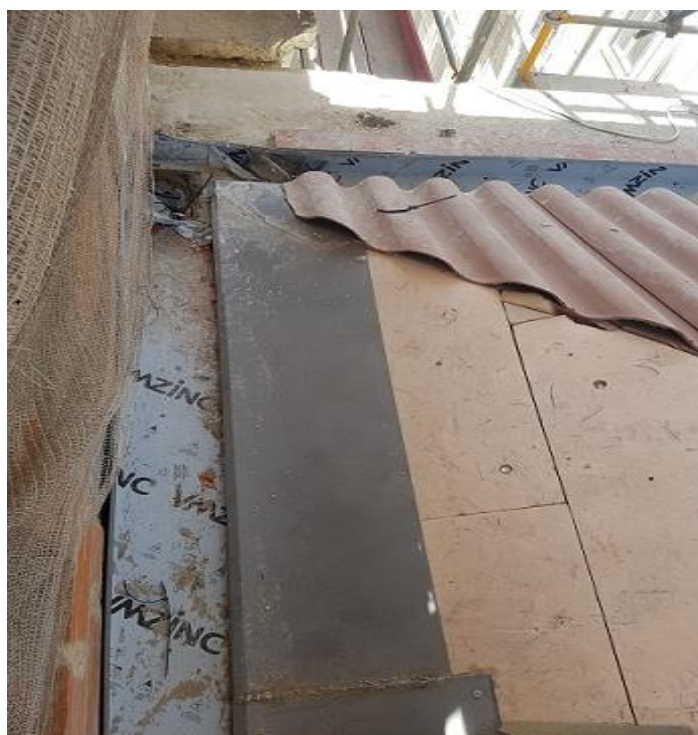
Figura 3.53 - Caleira na cobertura da zona do Arco, (imagem do autor, 2019).
