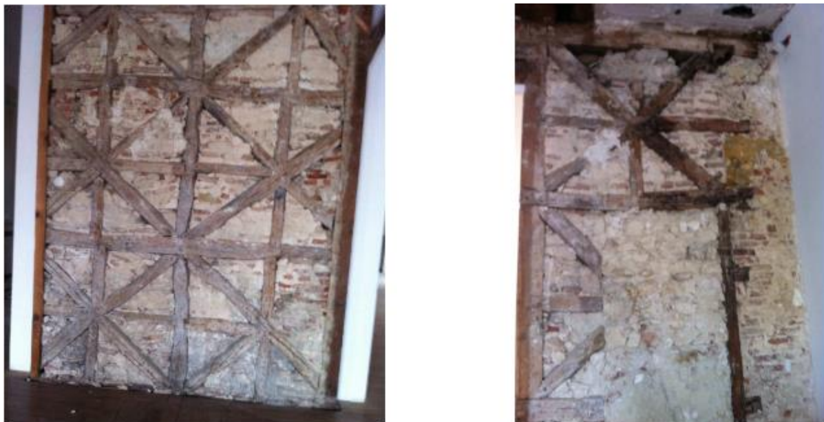
Figura 3.20 - Parede de frontal em bom estado de conservação e parede frontal alterada, (imagem do autor, 2019).
