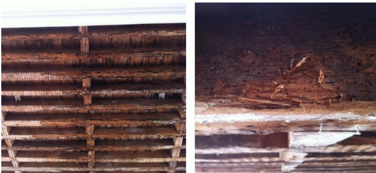
Figura 3.21 - Vigas de pavimento degradadas e com sinais de ataques de xilófagos, (imagem do autor, 2019).
