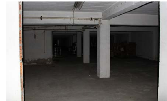
CAPTURA 1 - Empolamento da pintura - Pavimento com vestígios de humidade - Deterioração das tubagens (rede elétrica e rede de esgotos)
