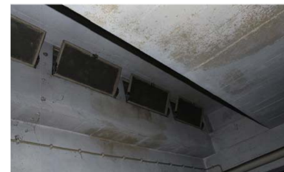
CAPTURA 2 - Lage e viga com vestígios de humidade - Empolamento da pintura - Corrosão de elementos metálicos não estruturais - Sujidade generalizada
