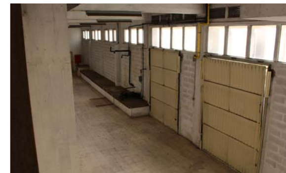
CAPTURA 3 - Empolamento da pintura - Filmes negros - Vidros e caixilharia danificada - Corrosão de elementos metálicos não estruturais - Pavimento danificado e sujo
