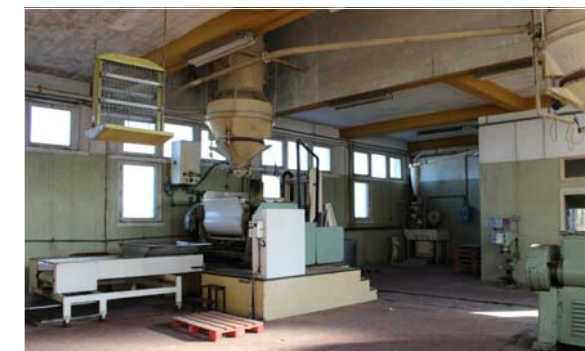
CAPTURA 8 - Lage com vestígios de humidade - Filmes negros - Paredes com vestígios de humidade - Pavimento danificado - Caixilharia danificada - Sujidade generalizada
