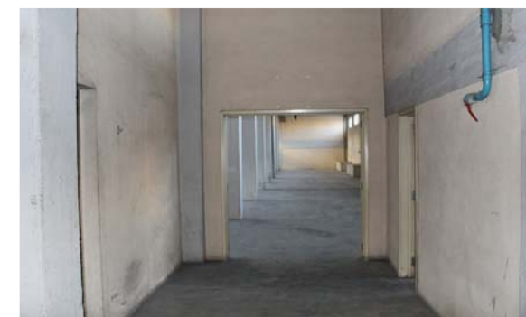
CAPTURA 4 - Sujidade generalizada - Carpintarias danificadas
