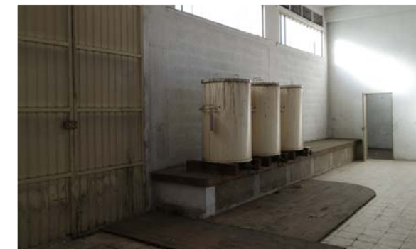
CAPTURA 4 - Empolamento da pintura - Filmes negros - Pavimento danificado e sujo - Corrosão de elementos metálicos não estruturais
