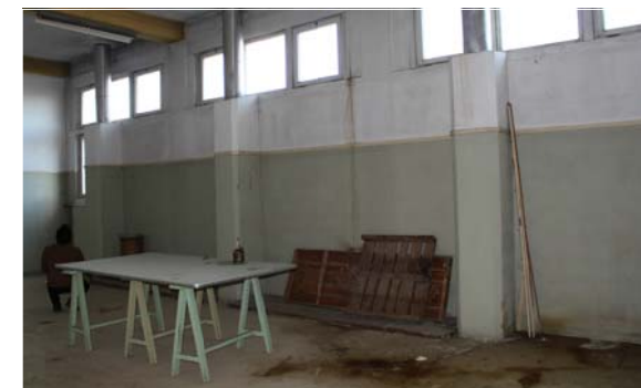
CAPTURA 7 - Paredes com vestígios de humidade e sujidade - Filmes negros - Corrosão de elementos metálicos não estruturais - Pavimento danificado e sujo
