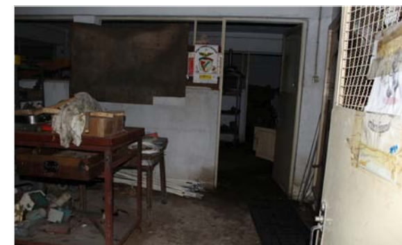
CAPTURA 1 - Empolamento da pintura - Pavimento com humidade - Filmes negros - Corrosão de elementos metálicos não estruturais
