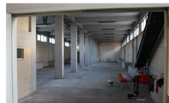
CAPTURA 5 - Paredes com manchas de humidade e sujidade - Pavimento danificado e sujo - Carpintarias danificadas
