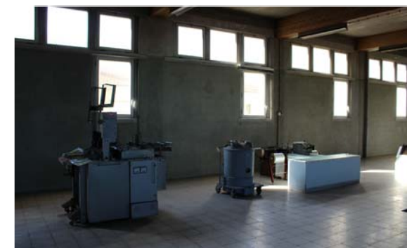
CAPTURA 5 - Paredes com vestígios de humidade e sujidade - Caixilharia danificada - Corrosão de elementos metálicos não estruturais - Pavimento danificado e sujo
