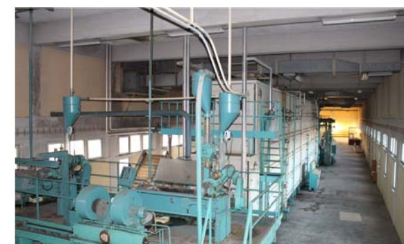
CAPTURA 6 - Paredes com vestígios de humidade e sujidade - Pavimento danificado e sujo - Lage com vestígios de humidade
