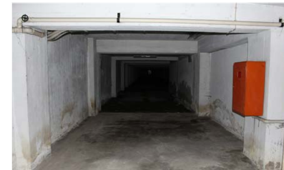
CAPTURA 2 - Empolamento da pintura - Pavimento com vestígios de humidade - Deterioração das tubagens (rede elétrica e rede de esgotos)
