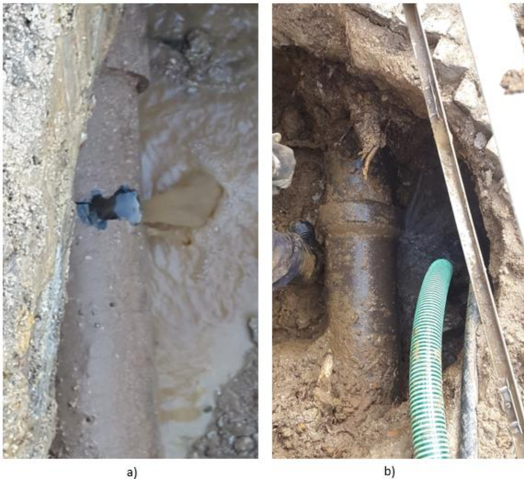
Figura 15 – Exemplos de roturas em redes de abastecimento. a) Rotura em conduta de fibrocimento DN200 na Abrunheira. b) Rotura em conduta de fibrocimento DN100 na Portela de Sintra (Imagens cedidas pelos SMAS – Sintra, 2022).
