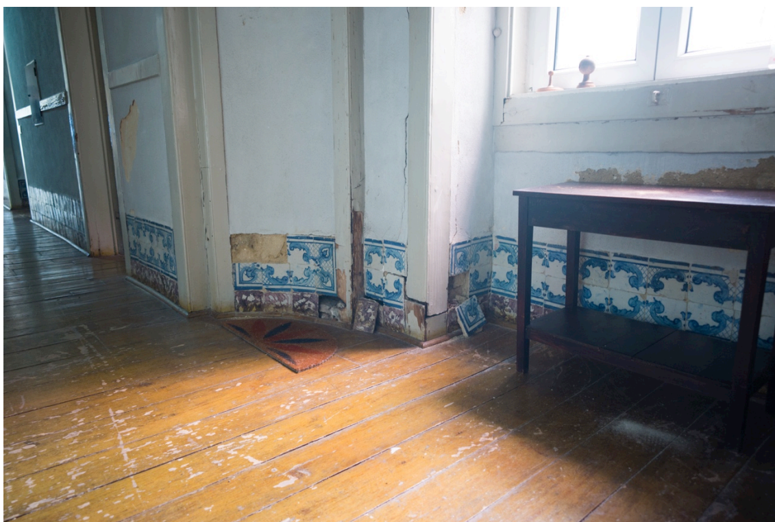
Figura 31. Azulejos pombalinos em corredor, que deverão ser restaurados.
