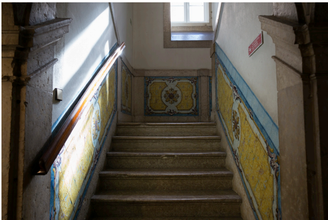
Figura 30. Azulejos pombalinos na escadaria principal, que deverão ser restaurados.
