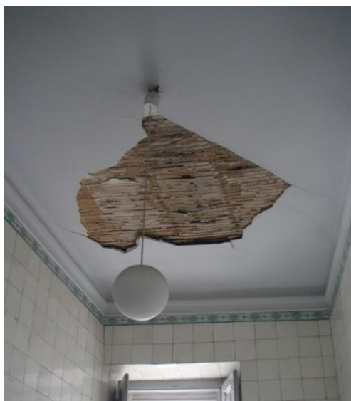
Fig.2.9.- Tecto fissurado com destacamento do estuque
