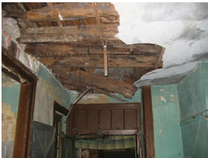
Fig.2.1. - Rotura local de viga de pavimento de madeira
