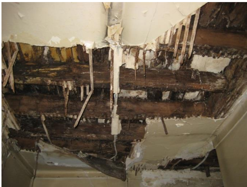
Fig.2.10.- Queda de tecto estucado por infiltração de água
