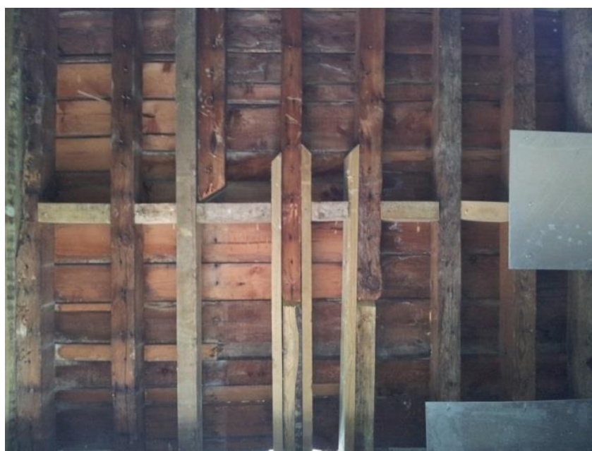
Fig.3.1.- Empalmes realizados em duas vigas de um pavimento
