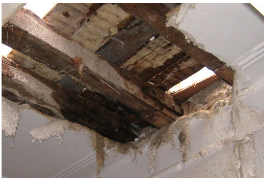
Fig.2.2.- Entrega de viga atacada por fungos de podridão
