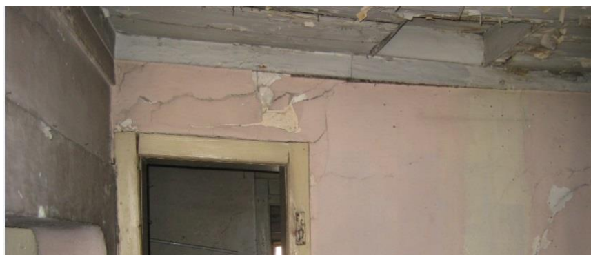
Fig.2.3.- Consequência da deformação excessiva das vigas - Fendilhação da parede
