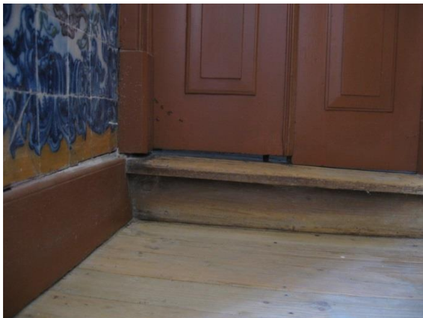
Fig.2.4.- Consequência da deformação excessiva das vigas - Desnível de porta
