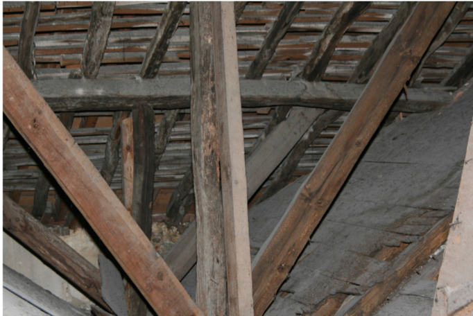
Fig.148. Pormenor da estrutura, zona dos caixotões, com duplicação do varedo (fonte: Teixeira Trigo, Lda, Diagnóstico Estrutural)
