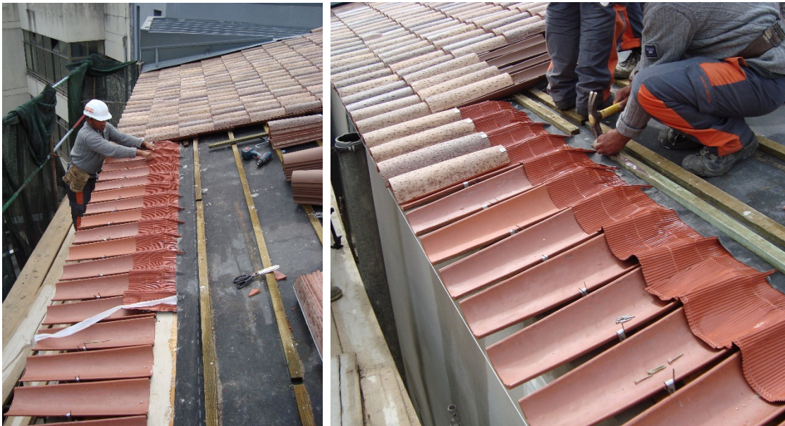
Fig. 101 Fixação dupla de beirados bica e capa . aparafusamento e grampo especial fonte: DAC.DAT UM (2008)
