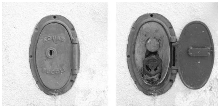
Figura 14 - Boca-de-incêndio típica (Fonte: Rodrigues, et al.,2005, p.21)
