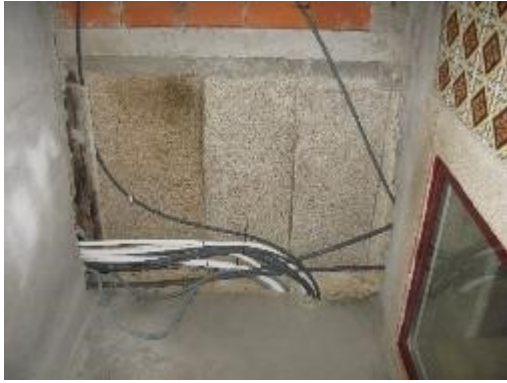
Fig. 89. Tubagens de Ar Condicionado (2012/15)
