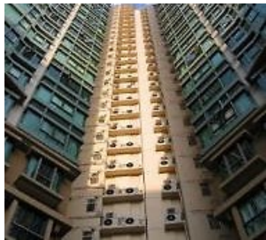
Fig. 64. Ritmo e Coerência dos Sistemas Instalados
