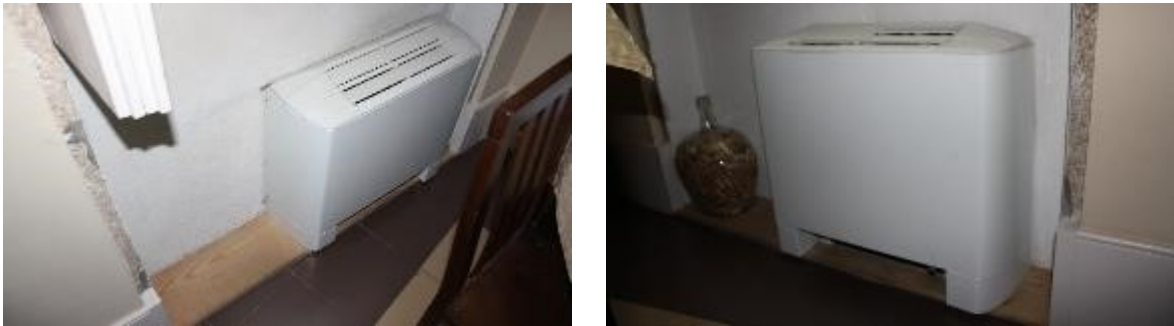
Fig. 100. Ventilo-Convetores Inseridos nos Nichos dos Parapeitos das Janelas (aproveitamento da instalação realizada em 2012/15)
