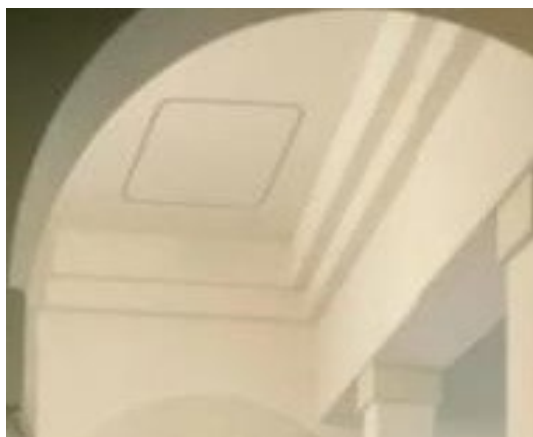
Fig. 44. Alçapão de Inspeção Teto Falso
