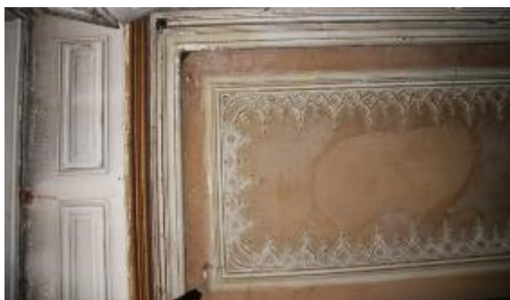
Fig. 104. Infiltrações no Corredor
