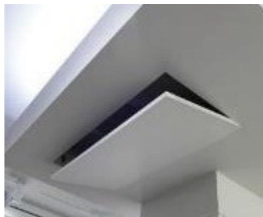
Fig. 45. Alçapão de Inspeção em Teto Falso
