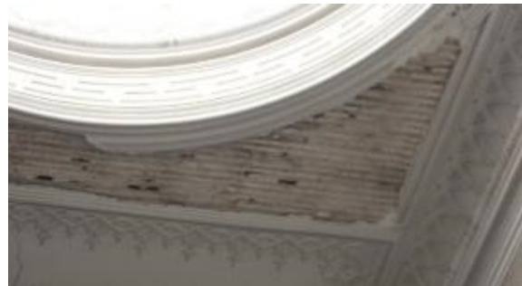
Fig. 103. Desagregação na Claraboia
