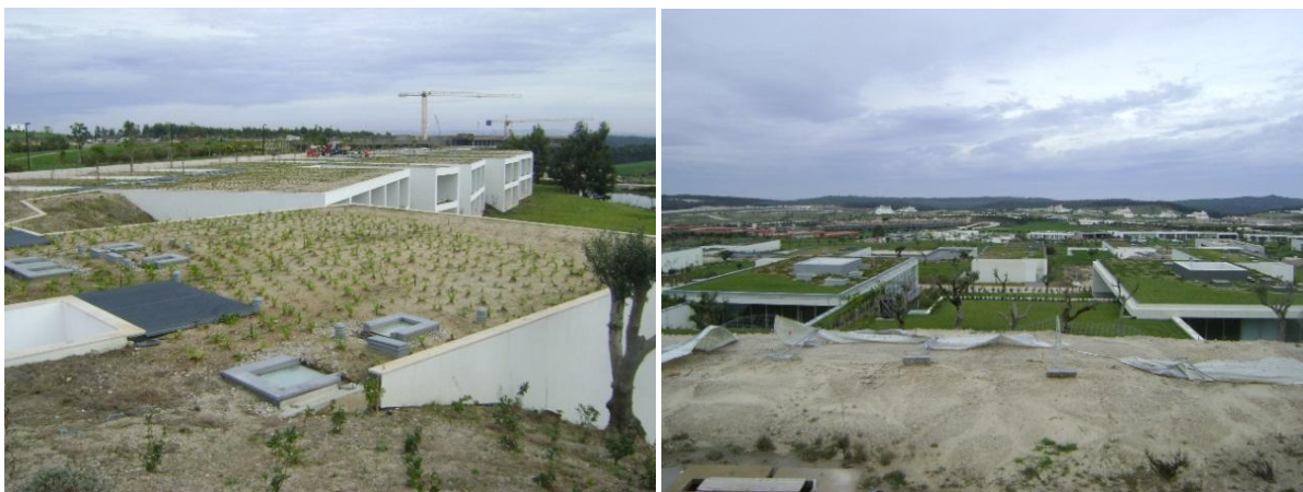
Figura 161 e 161a - Coberturas verdes extensivas
