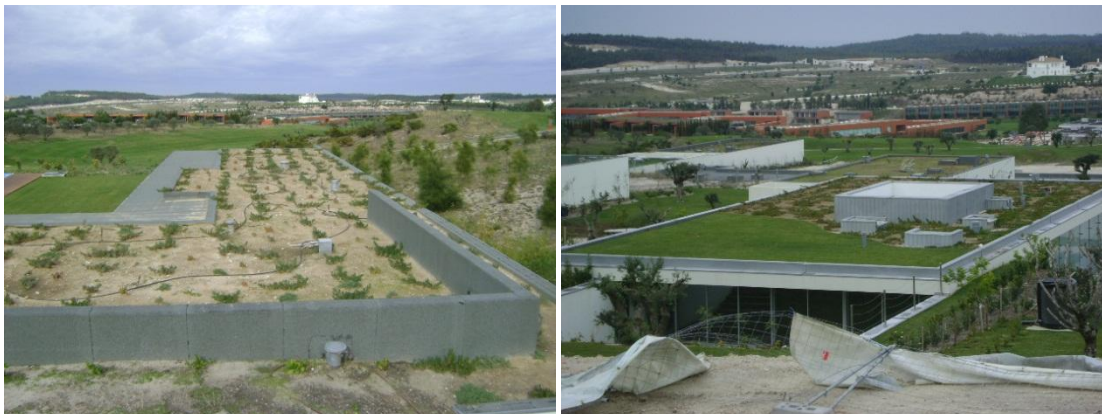
Figura 162 e 162a - Coberturas verdes extensivas
