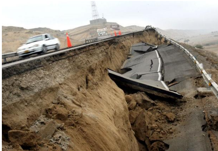
Figura 3.14 - Danos nas infraestruturas rodoviárias com o abalo sísmico no Perú (Martin, 2017)
