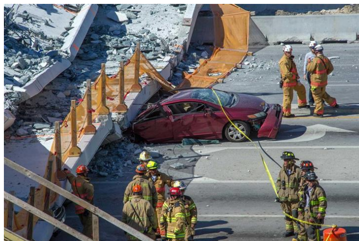
Figura 3.35 - Colapso da PSP em Miami atingindo várias viaturas que circulavam na via inferior (Queda de ponte pedonal em Miami, 2018)
