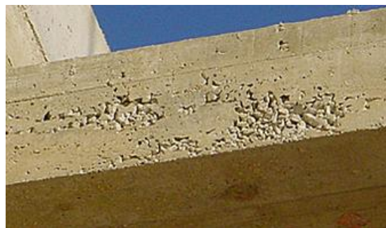
Figura 3.26 - Segregação do betão (Reparação de betão com danos superficiais, 2018)
