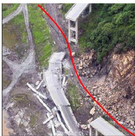
Figura 3.18 - Zona curva do tabuleiro que colapsou com marcação da falha (Costa, Ferreira, & Oliveira, 2010)
