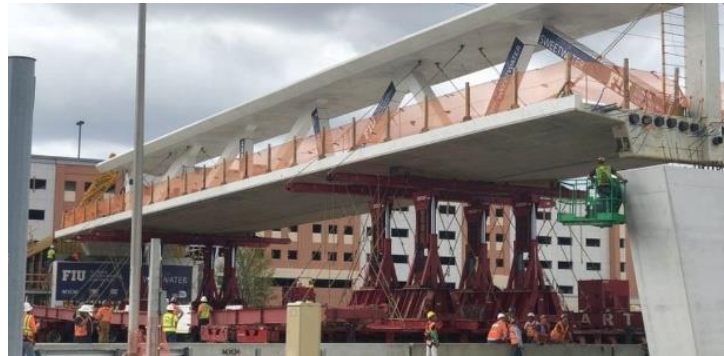
Figura 3.34 - Passagem superior pedonal em Miami - Flórida (Queda de ponte pedonal em Miami, 2018)
