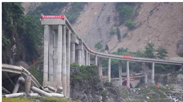
Figura 3.17 - Ponte de Baihua após o sismo (Costa, Ferreira, & Oliveira, 2010)
