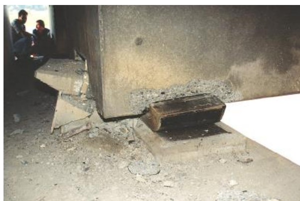
Figura 3.33 - Deslocamento excessivo no apoio (Guerreiro, 2011)
