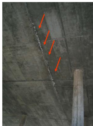
Figura 3.28 - Descontinuidades visíveis no betão (Paulo, Campos, & Alexandre, 2002)
