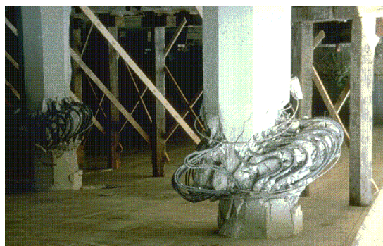
Figura 3.8 - Insuficiente resistência à solicitação axial (Delgado P. D., 2009)
