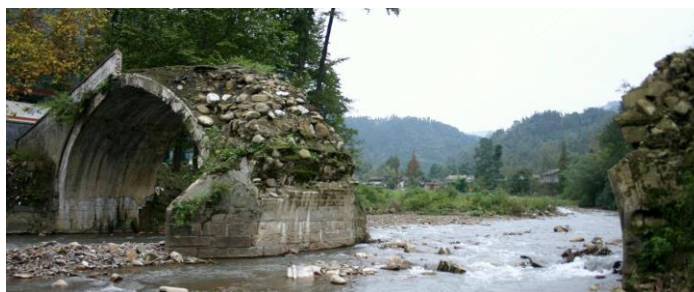
Figura 3.16 - Colapso de ponte em alvenaria de pedra por rotura do arco central (Costa, Ferreira, & Oliveira, 2010)
