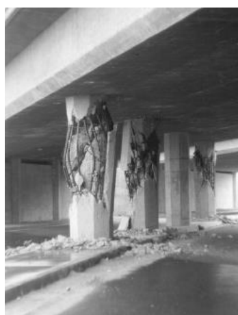
Figura 3.23 - Reforço de armadura transversal insuficiente (Guerreiro, 2011)
