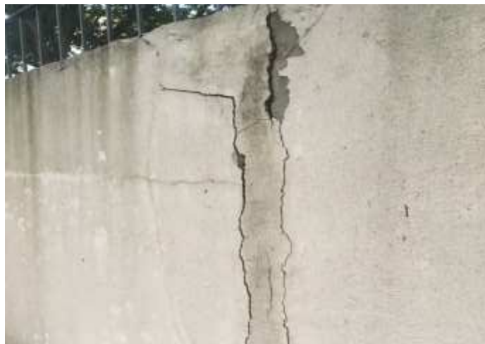
Figura 9 - Esmagamento de um muro (Autor, 2017)
