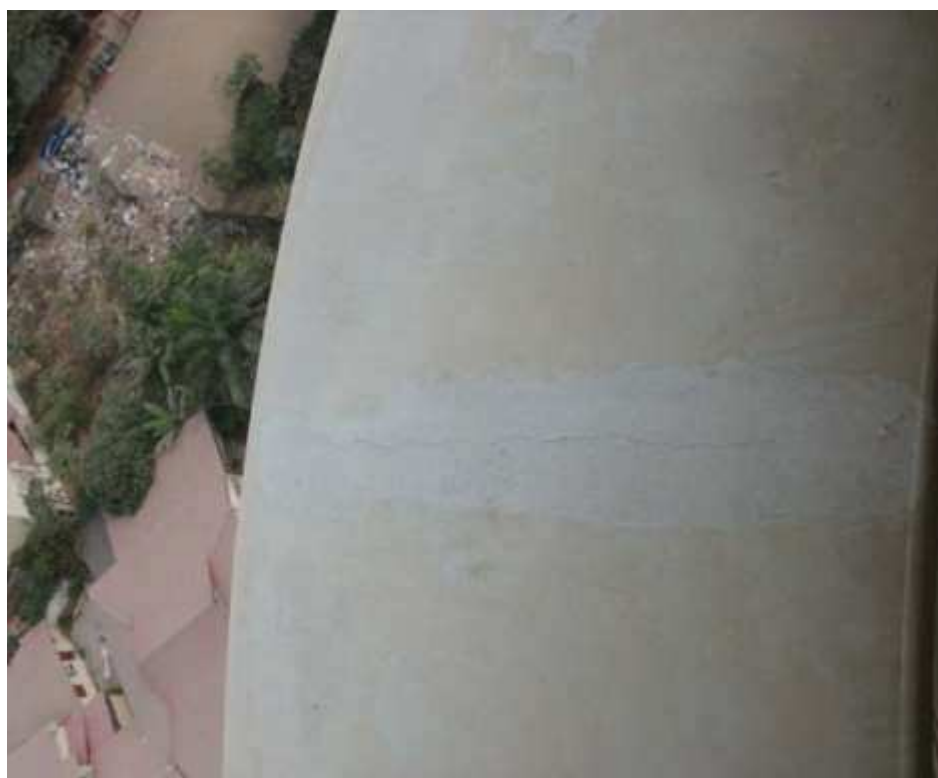
Figura 58 - Fissuração nas palas exteriores
