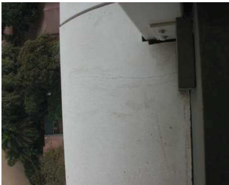
Figura 57 - Fissuração nas palas exteriores
