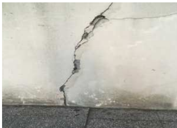
Figura 19 - Fissuração na parede (Autor, 2017)
