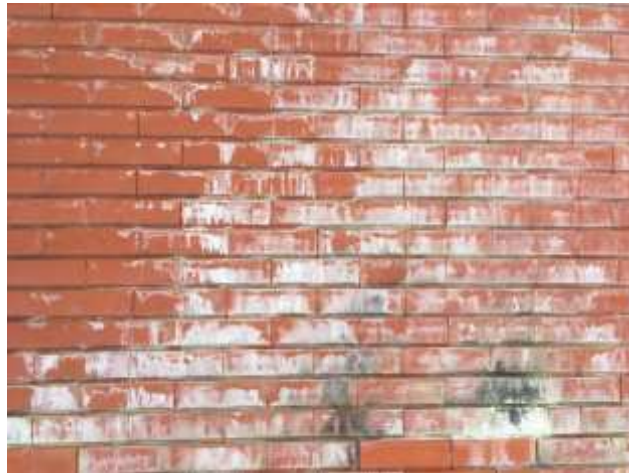
Figura 20 - Eflorescencias em parede (Autor, 2017)
