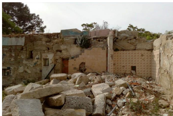
Figura 149 – Pré-existência em estado de ruína, 2018, Porto
