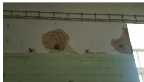
Figura 28 - Destacamento de rebocos em paredes, fonte: Autor
