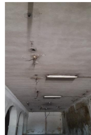
Figura 22 - Destacamento de rebocos em teto, fonte: Autor
