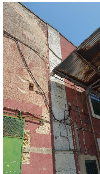
Figura 67 - Cantaria fraturada na fachada sul da rua da Manutenção Militar, fonte: Autor
