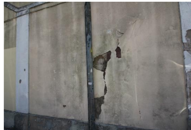
Figura 42 - Desagregação da parede, fonte: Autor
