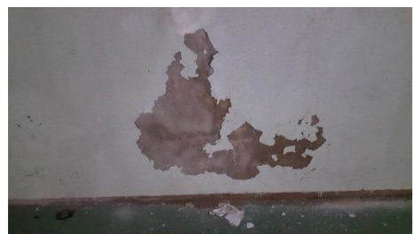
Figura 31 - Destacamento de pintura em parede, fonte: Autor
