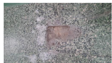
Figura 32 - Desagregação do pavimento, fonte: Autor
