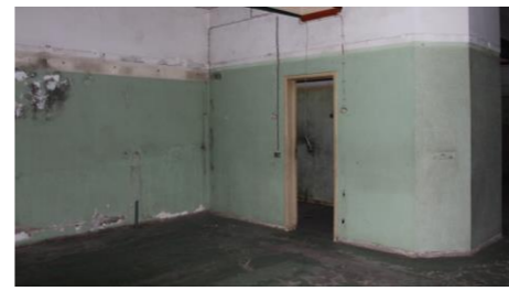
Figura 33 - Destacamento de pintura em parede, fonte: Autor
