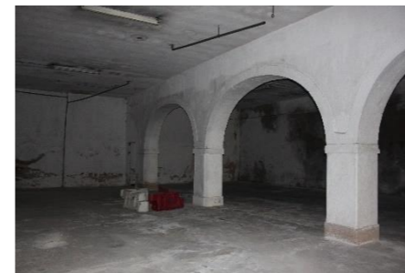
Figura 26 - Humidade e eflorescências, fonte: Autor
