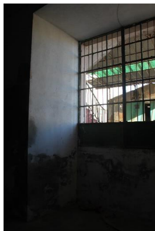
Figura 23 - Eflorescências em parede, fonte: Autor
