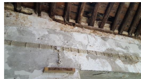
Figura 30 - Destacamento e desagregação de rebocos nos tetos e paredes, fonte: Autor
