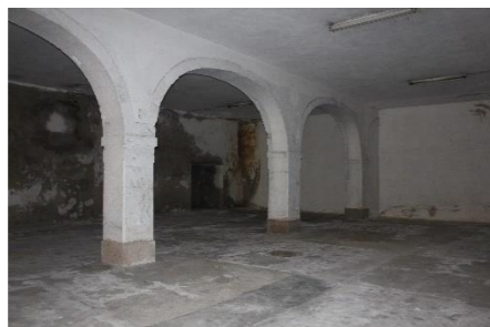
Figura 24 - Humidade e eflorescência generalizada, fonte: Autor
