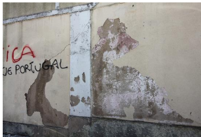
Figura 41 - Destacamento da pintura, fonte: Autor
