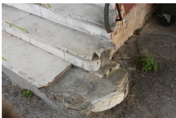
Figura 63 - Pormenor de escada fraturada, fonte: Autor
