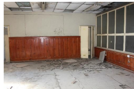
Figura 25 - Pavimento destruído, fonte: Autor
