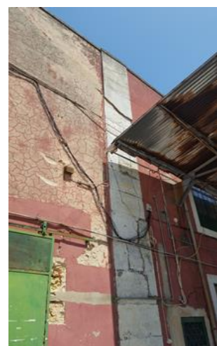
Figura 35 - Desagregação da parede, Fonte: Autor
