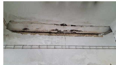
Figura 29 - Desagregação de Revestimentos em tetos, fonte: Autor
