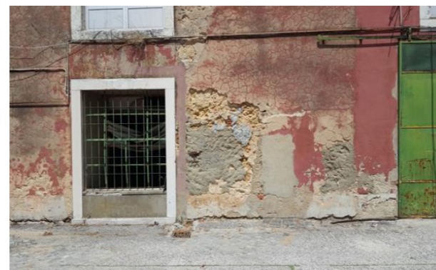
Figura 39 - Florescência da parede, fonte: Autor
