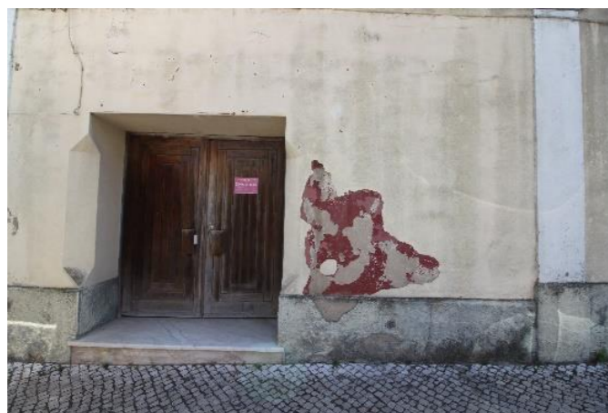
Figura 43 - Destacamento de reboco e da pintura, fonte: Autor
