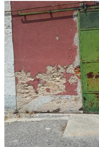
Figura 37 - Destacamento de rebocos em fachada, fonte: Autor
