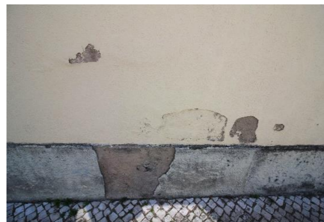
Figura 44 – Desagregação e destacamento de reboco em parede, fonte: Autor
