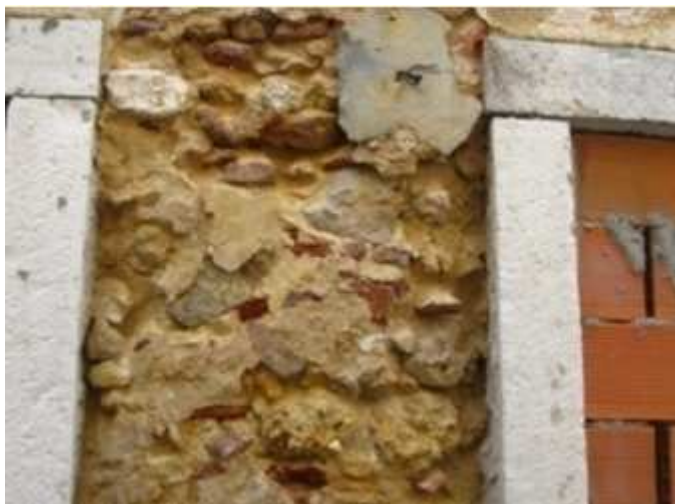
Figura 116 – Exemplo de desagregação existente na fachada poente do edifício. (Fonte: Foto do autor tirada no dia 28 de Abril de 2011)
