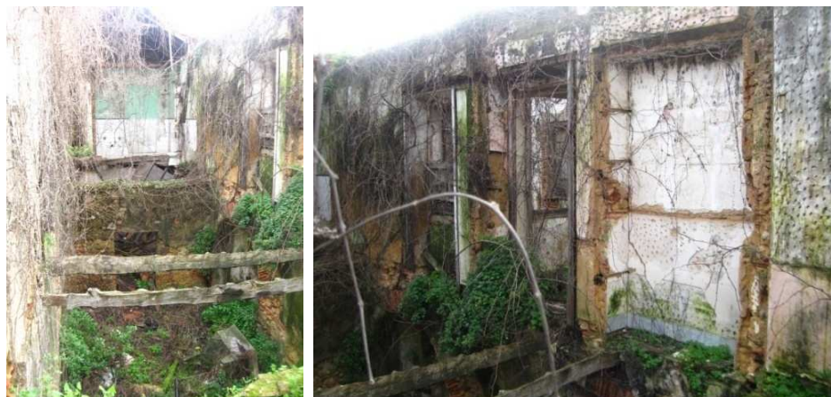
Figura 061 e 062 – Fotografias da ruína do corredor do piso 1 na ala norte. (Fonte: Foto do autor tirada no dia 26 de Janeiro de 2011)
