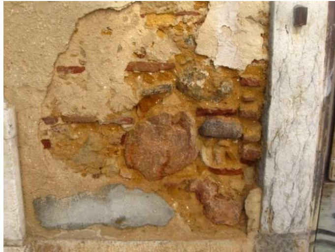
Figura 100 – Exemplo de revestimento em mau estado. (Fonte: Foto do autor tirada no dia 2 de Fevereiro de 2011)
