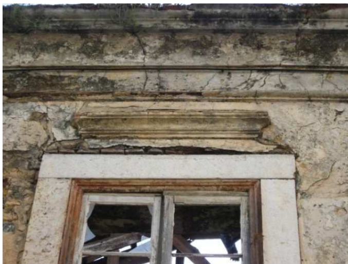
Figura 129 – Fendilhação existente num vão da fachada principal. (Fonte: Foto do autor tirada no dia 28 de Abril de 2011)
