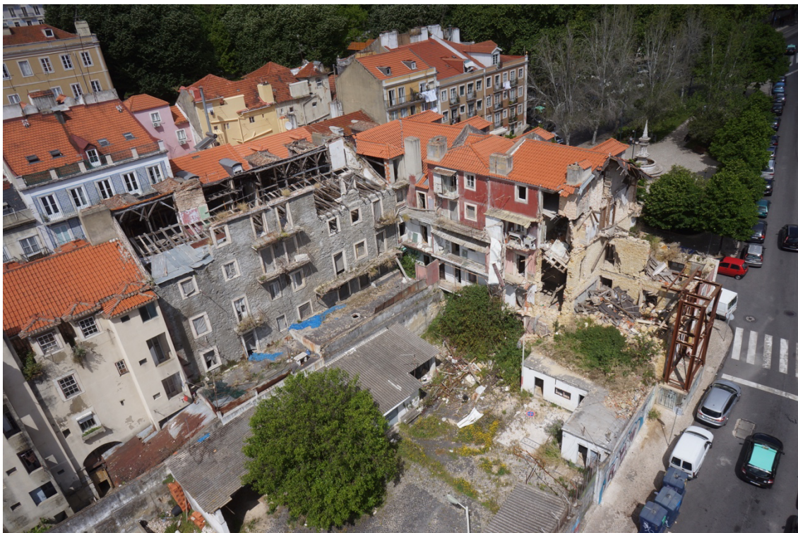
Figura 69. Largo do Mastro, 1 a 10; o estado de conservação dos edifícios era mau, tendo inclusive ruído uma parte.
