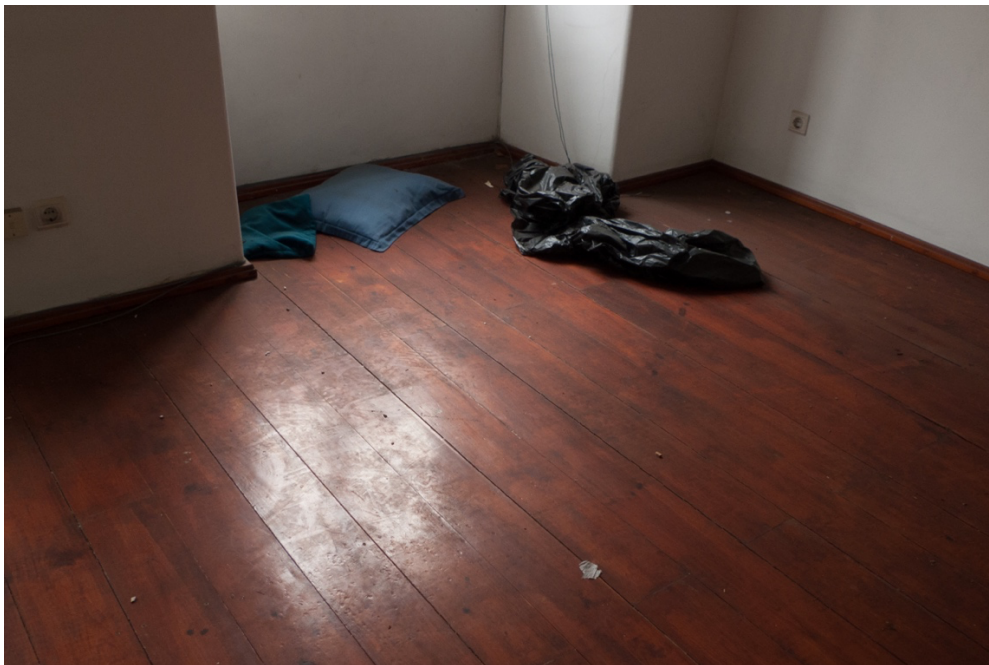
Figura 45. Rua Serpa Pinto, 5; Soalho de madeira recente sobreposto ao soalho antigo.
