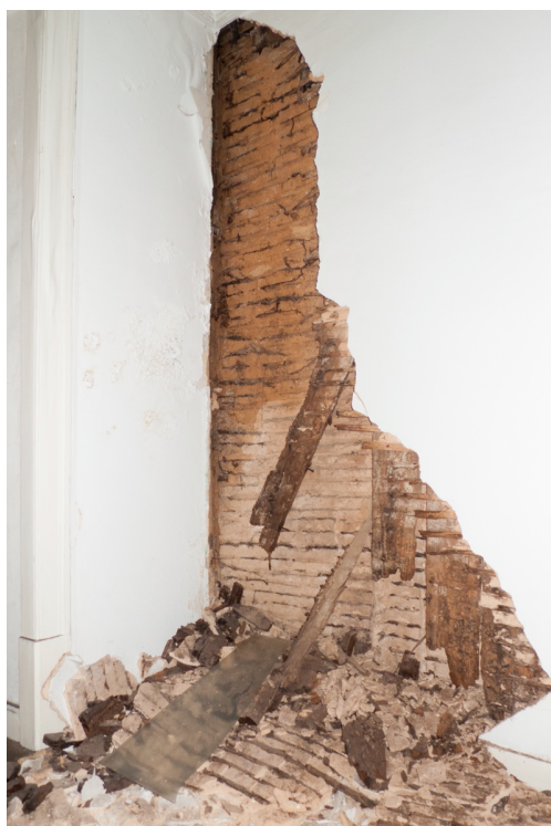
Figura 32. Rua Serpa Pinto, 5; Tabique de frontal com prumos e travessas apodrecidos devido a infiltrações.
