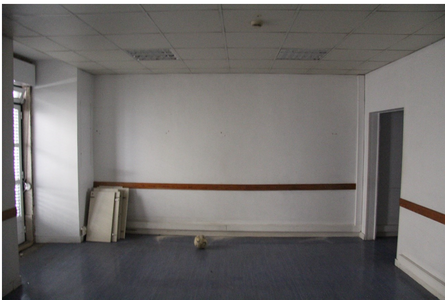
Figura 64. Rua Serpa Pinto, 5; Interior de compartimento voltado para a rua apresentado teto falso recente que não deixa verificar o teto original.
