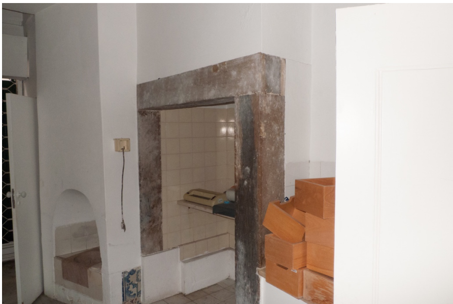
Figura 61. Rua Serpa Pinto, 5; Aspeto de uma lareira, vendo-se em baixo alguns azulejos sem continuidade.
