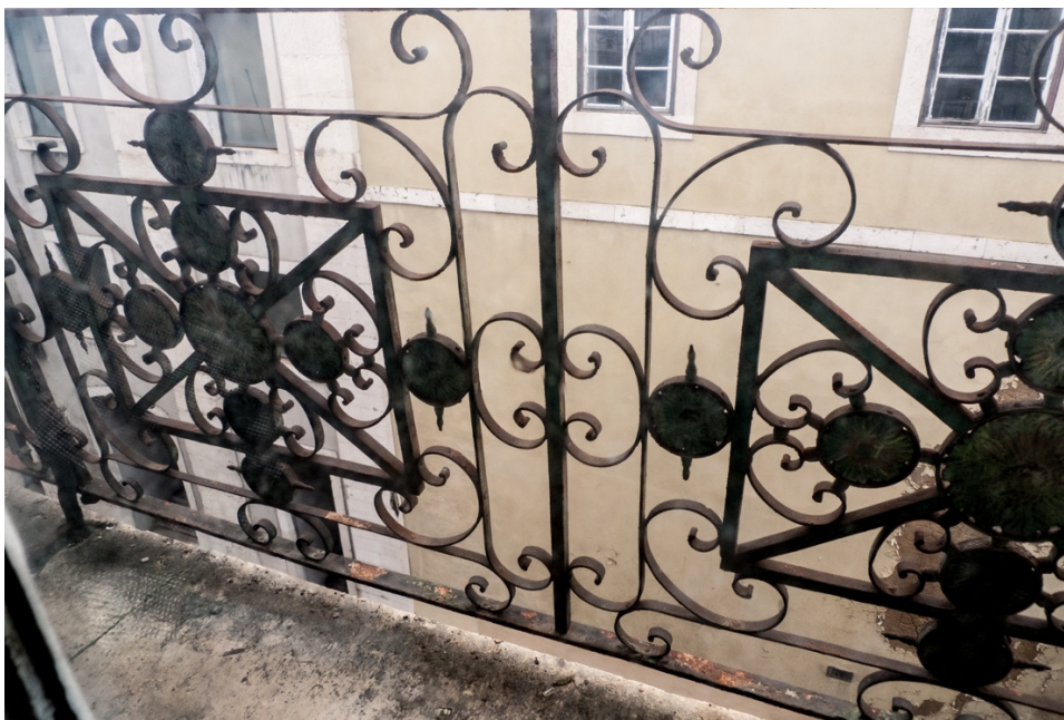
Figura 18. Rua Serpa Pinto, 5; Aspeto do gradeamento da varanda do terceiro andar.
