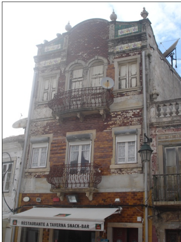
Figura 15 - Edifício no largo de S. João números 11 e 12 Edifício em mau estado de conservação. Fonte: o próprio. 2010.
