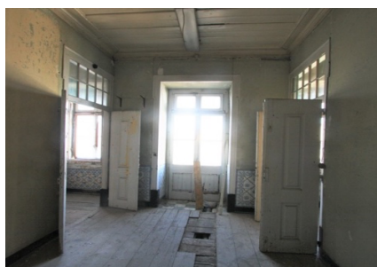
Figura 94. Segundo andar; pavimento em madeira muito degradado com ausência de régua deixando a estrutura à vista, degradação de paredes por empolamentos e desagregações.
