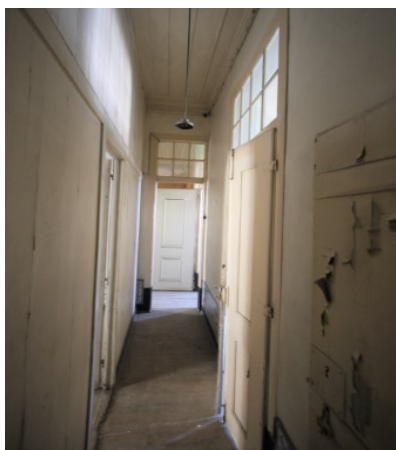
Figura 100. Segundo andar; elementos em madeira degradados com empolamentos de tinta.
