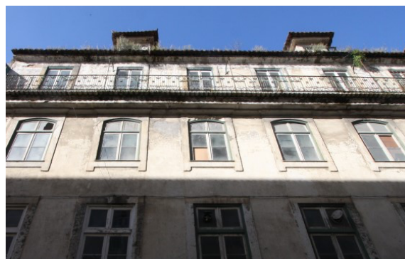
Figura 49. Beirado danificado com telhas partidas, presença de vegetação parasitária, cantarias com presença de sujidade e danificados.
