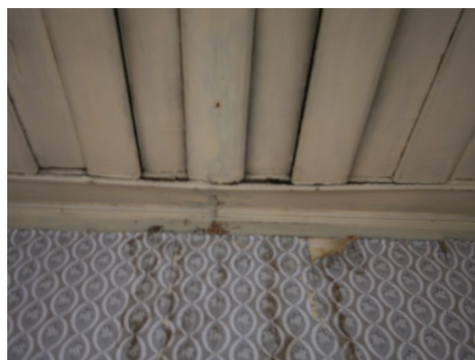
Figura 109. Terceiro andar; pormenor de teto degradado com empolamento de tinta e desprendimento de tábuas de madeira.
