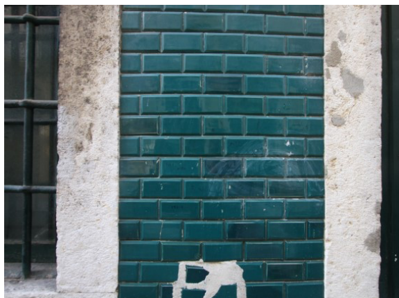
Figura 50. Azulejos em falta no piso térreo.
