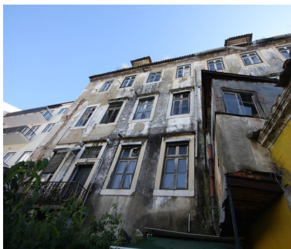
Figura 51. Fachada tardoza em muito mau estado de conservação, reboco muito degradado deixando a alvenaria de pedra à vista, presença de vegetação parasitária, presença de manchas de humidade, ausência de pintura, vãos e caixilharia degradados.
