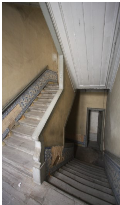
Figura 67. Escadaria principal; revestimento azulejar apresentando falhas.
