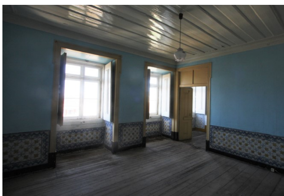
Figura 110. Terceiro andar; degradação do pavimento em madeira junto à fachada, ausência de azulejos em zona pontuais.
