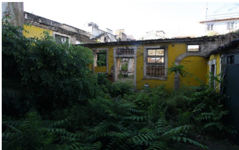
Figura 53. Aspecto do logradouro com anexos em situação de pré ruína e vegetação parasitária.
