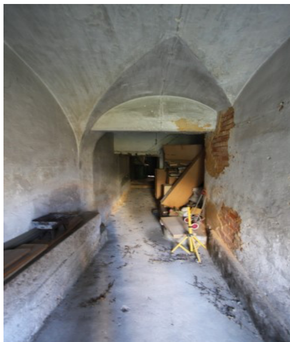
Figura 59. Piso térreo; presença de humidade por capilaridade originando o empolamento e desprendimento do acabamento das paredes, pavimento com elevado nível de erosão.
