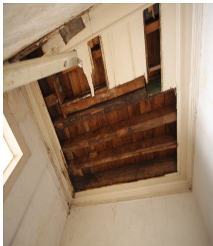
Figura 98. Segundo andar; degradação do teto com apodrecimento da madeira e ausência de tábuas; elementos em madeira degradados com empolamentos de tinta.
