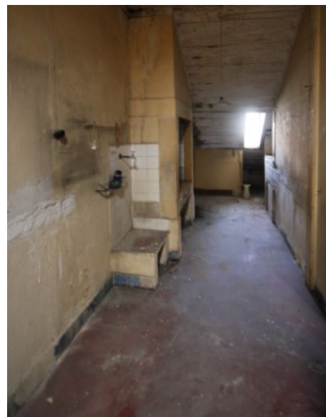
Figura 120. Quarto andar; pavimento com elevado nível de desgaste; paredes com presença de manchas de humidade, teto degradado e com presença de manchas de humidade.
