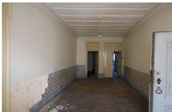
Figura 104. Terceiro andar; degradação do pavimento em madeira, ausência de azulejos, elementos em madeira degradados com empolamentos de tinta.
