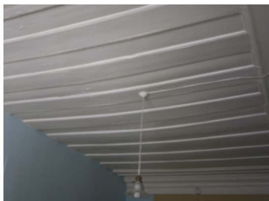
Figura 107. Terceiro andar; abaulamento em teto de madeira.
