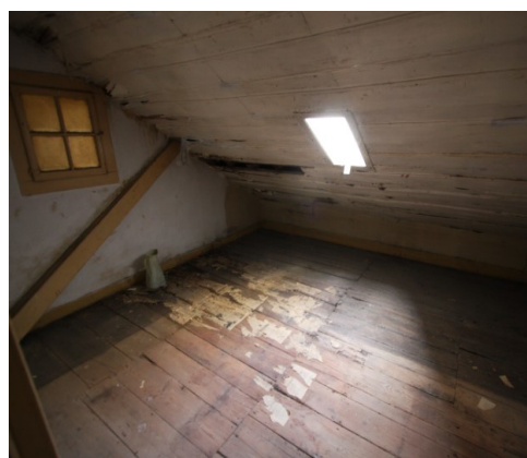
Figura 122. Quarto andar; pavimento com elevado nível de desgaste, teto muito degradado e apodrecido por infiltrações, degradação de paredes por empolamentos, desagregações e infiltrações
