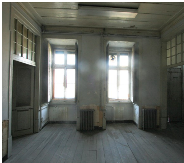
Figura 79. Primeiro andar; degradação do pavimento em madeira, ausência de azulejos, degradação de paredes por empolamentos e desagregações, elementos em madeira degradados com empolamentos de tinta.
