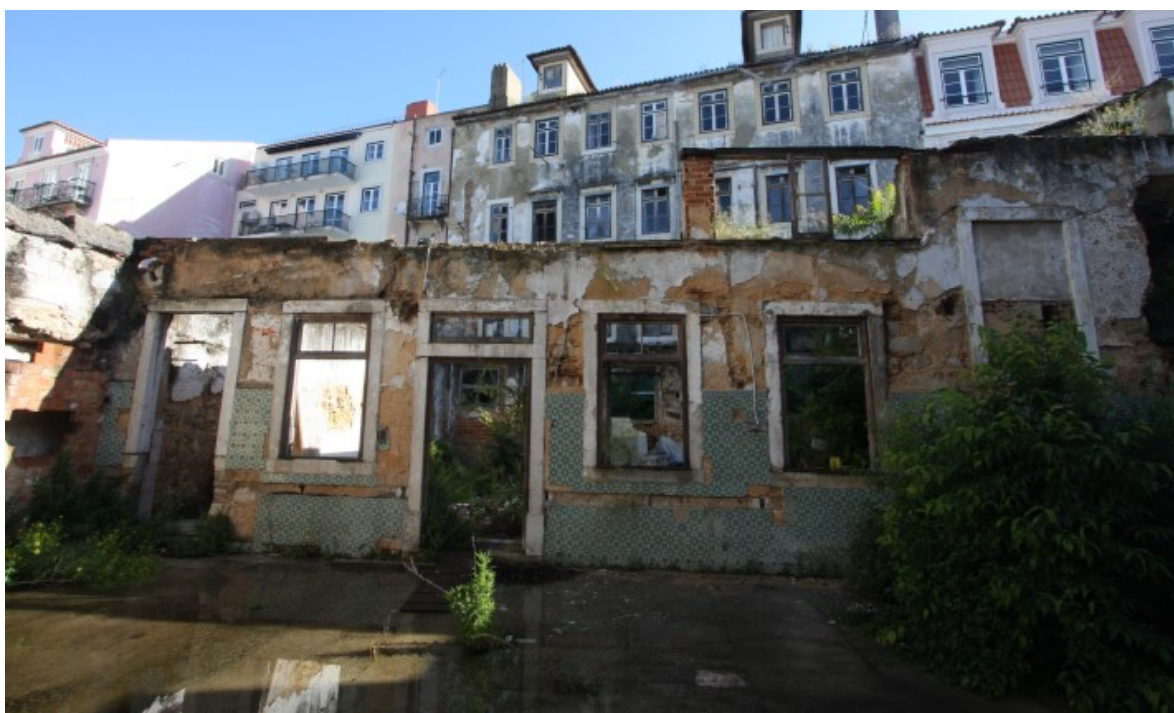
Figura 52. Aspecto dos anexos existentes no logradouro, em estado de pré ruína.
