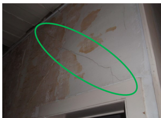
Figura 78. Fenda cruzada em parede de travamento
