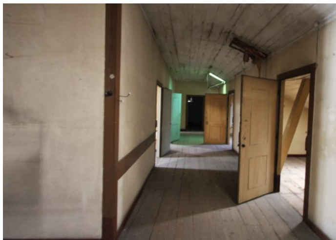
Figura 119. Quarto andar; pavimento com elevado nível de desgaste; paredes com presença de manchas de humidade, teto degradado e com presença de manchas de humidade.
