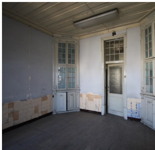
Figura 80. Primeiro andar; degradação do pavimento em madeira, ausência de azulejos, degradação de paredes por empolamentos e desagregações, elementos em madeira degradados com empolamentos de tinta.
