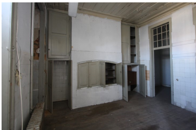
Figura 81. Primeiro andar; degradação do pavimento em madeira, degradação de paredes por empolamentos e desagregações, elementos em madeira degradados com empolamentos de tinta.
