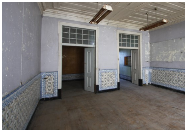
Figura 89. Segundo andar; degradação do pavimento em madeira, degradação de paredes por empolamentos e desagregações, degradação dos tetos com empolamentos de tinta.
