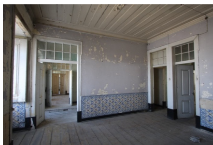
Figura 93. Segundo andar; pavimento em madeira muito degradado com ausência de régua deixando a estrutura à vista.
