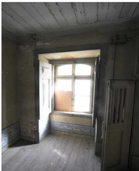
Figura 86. Segundo andar; degradação do pavimento em madeira, ausência de azulejos em zonas pontuais, degradação de paredes por empolamentos e desagregações, elementos em madeira degradados com empolamentos de tinta, degradação dos tetos com empolamentos de tinta.
