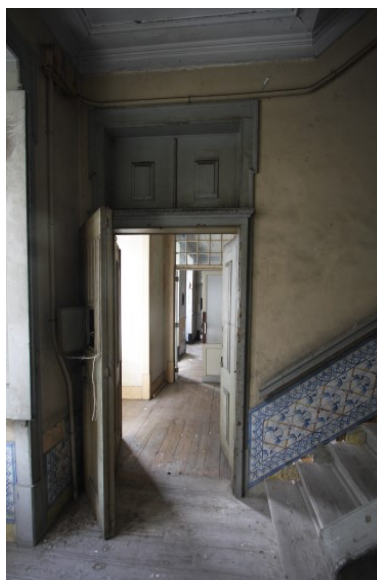
Figura 85. Segundo andar; degradação do pavimento em madeira, ausência de azulejos, degradação de paredes por empolamentos e desagregações, elementos em madeira degradados com empolamentos de tinta.
