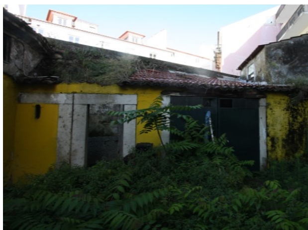
Figura 55. Logradouro: Telheiro com sinais de corrosão elementos danificados.
