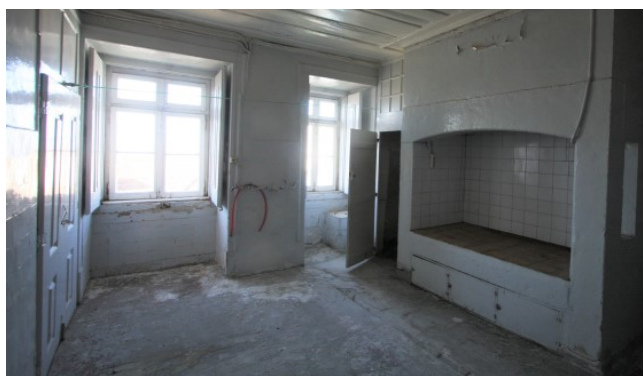
Figura 114. Terceiro andar; degradação do pavimento, degradação de paredes por empolamentos e desagregações e existência de fendilhação na zona da fachada, elementos em madeira degradados, com empolamentos de tinta, teto degradado com empolamento de tinta e desprendimento de tábuas de madeira.
