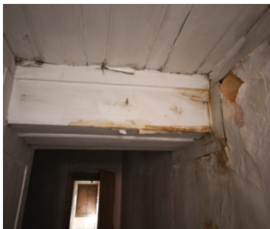
Figura 123. Quarto andar; teto muito degradado e apodrecido por infiltrações, degradação de paredes por empolamentos, desagregações e infiltrações.
