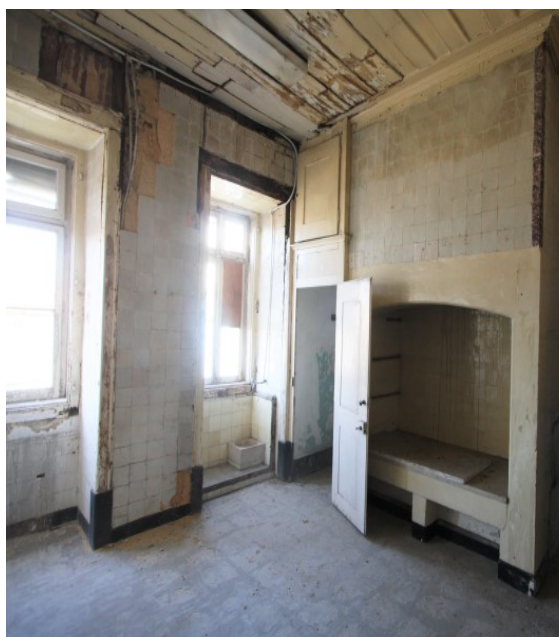
Figura 96. Segundo andar; degradação do pavimento, degradação de paredes por empolamentos e desagregações, paredes da fachada tardoz em elevado estado de degradação devido a infiltrações, degradação dos tetos com empolamentos de tinta e apodrecimento da madeira junto à fachada, elementos em madeira degradados com empolamentos de tinta, ausência de azulejos em zona pontual.
