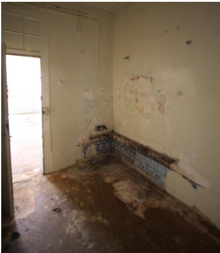
Figura 116. Terceiro andar; degradação do pavimento devido a infiltrações, deterioração de paredes por empolamentos e fragmentações e existência de manchas de humidade; ausência de azulejos na maior parte da divisão.
