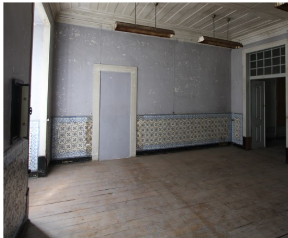
Figura 88. Segundo andar; degradação do pavimento em madeira, ausência de azulejos em zonas pontuais, degradação de paredes por empolamentos e desagregações, degradação dos tetos com empolamentos de tinta, fechamento de vão sem acabamento.
