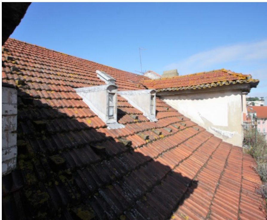
Figura 126. Cobertura degradada com colonização biológica.
