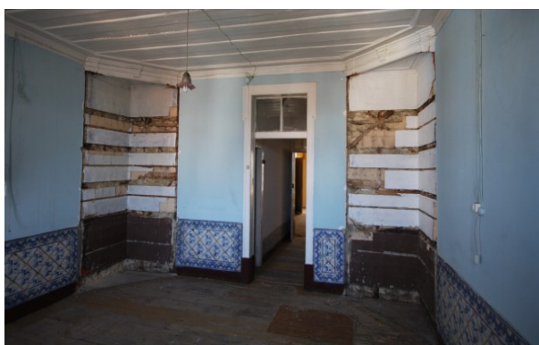
Figura 113. Terceiro andar; degradação do pavimento em madeira, teto degradado com empolamento de tinta.
