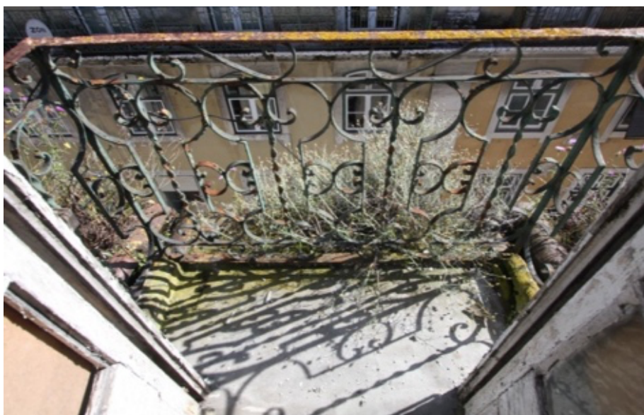
Figura 125. Quarto andar; guarda em ferro fundido com sinais de corrosão e oxidação, reboco degradado com empolamentos e desagregações, caixilharia apodrecida devido a infiltrações, presença de vegetação parasitária na fachada.
