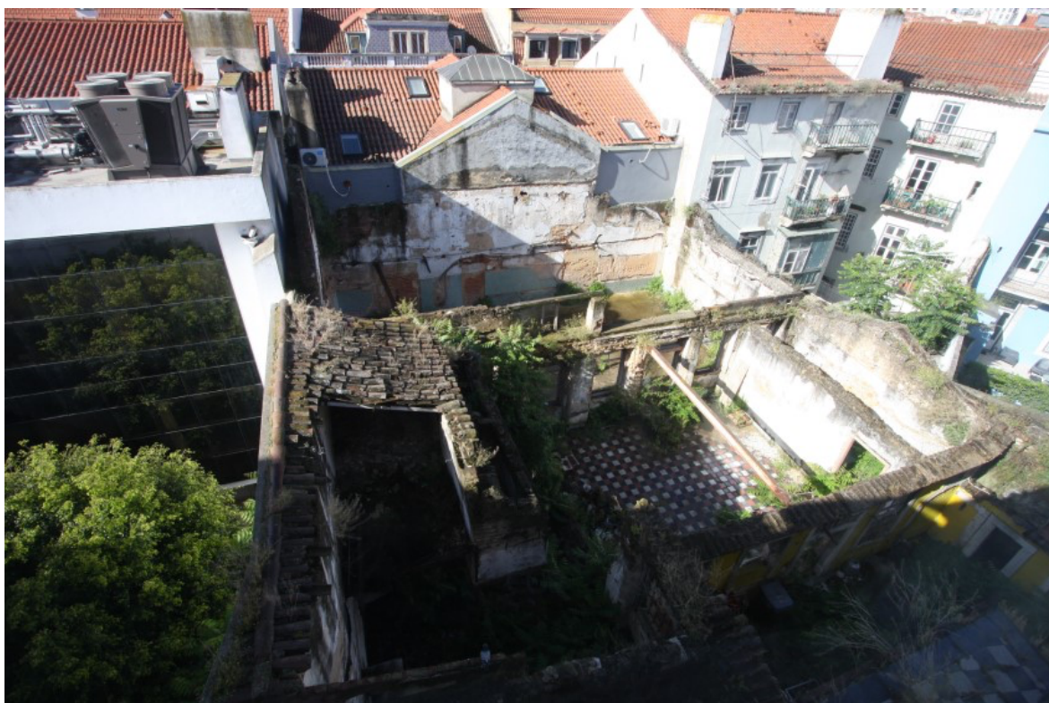
Figura 57. Logradouro; edifícios em pré ruína.
