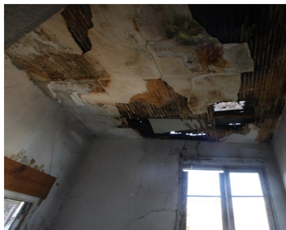
Figura 76. Primeiro andar; teto em elevado nível de degradação devido à infiltrações.
