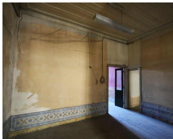
Figura 72. Primeiro andar; degradação do pavimento em madeira, presença de humidade nas paredes e teto, degradação de paredes por empolamentos e desagregações.
