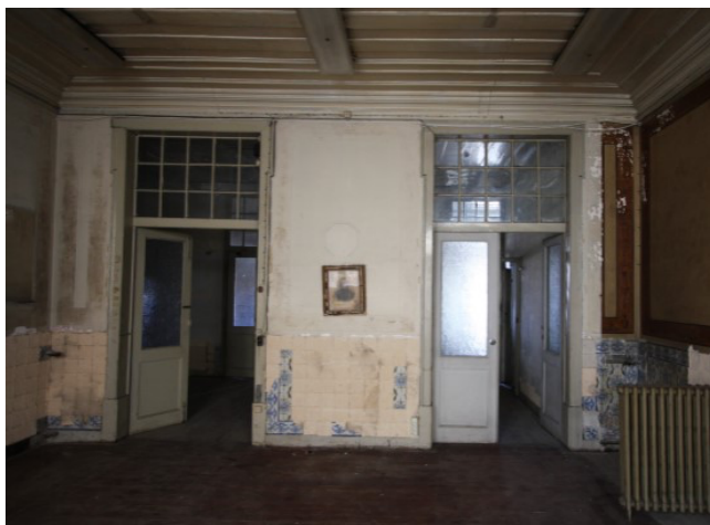
Figura 70. Primeiro andar; Fendilhação vertical na ligação entre paredes e teto, degradação do pavimento em madeira, ausência de azulejos nas paredes.
