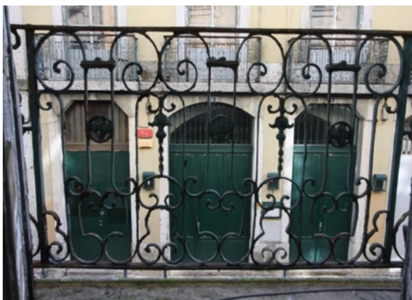
Figura 83. Primeiro andar; guarda em ferro fundido com sinais de corrosão e oxidação, reboco degradado com empolamentos e desagregações.
