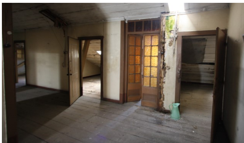
Figura 117. Quarto andar; Pavimento com elevado nível de desgaste, paredes com zonas apodrecidas por infiltrações, teto degradado e com presença de manchas de humidade.
