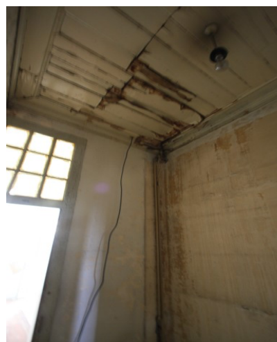
Figura 82. Primeiro andar; teto em madeira degradado e apodrecido devido à infiltrações, presença de manchas de humidade nas paredes.
