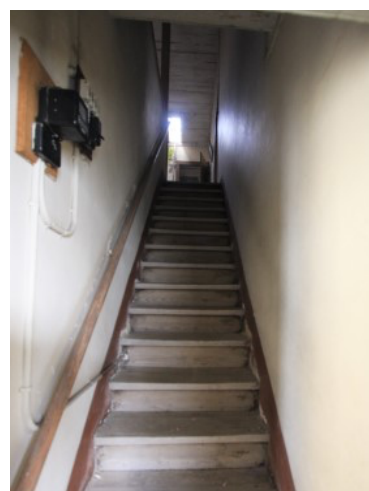
Figura 118. Quarto andar; escada de acesso ao sótão; paredes com presença de manchas de humidade.
