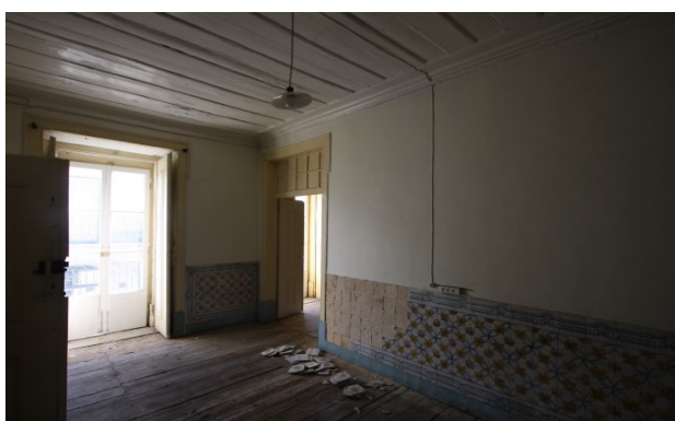
Figura 103. Degradação do pavimento em madeira, ausência de azulejos, elementos em madeira degradados com empolamentos de tinta.
