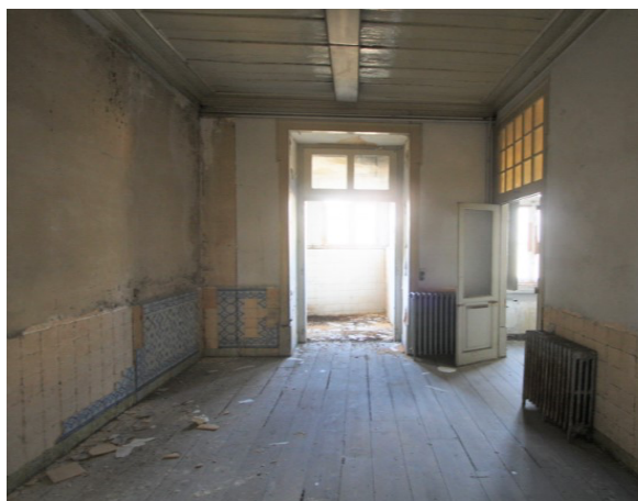
Figura 75. Primeiro andar; degradação do pavimento em madeira, ausência de azulejos, degradação de paredes por empolamentos e desagregações, presença de humidade nas paredes.
