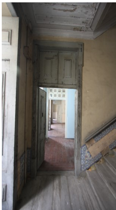
Figura 68. Primeiro andar; pavimento com elevado nível de desgaste, azulejos em falta, portas interiores em madeira com desagregação e desgaste do acabamento, teto desgastado, presença de manchas de humidade nas paredes.
