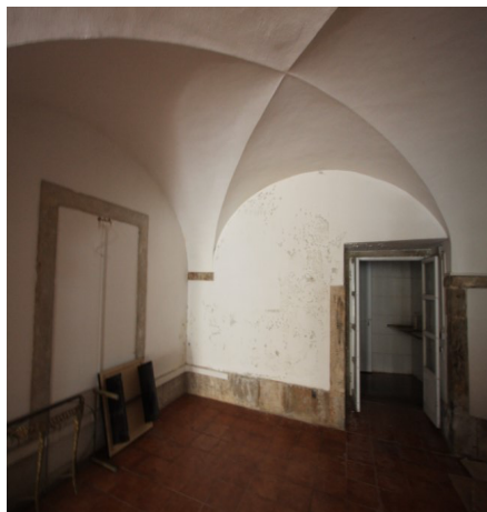
Figura 66. Espaço no piso térreo; presença de humidade em paredes.
