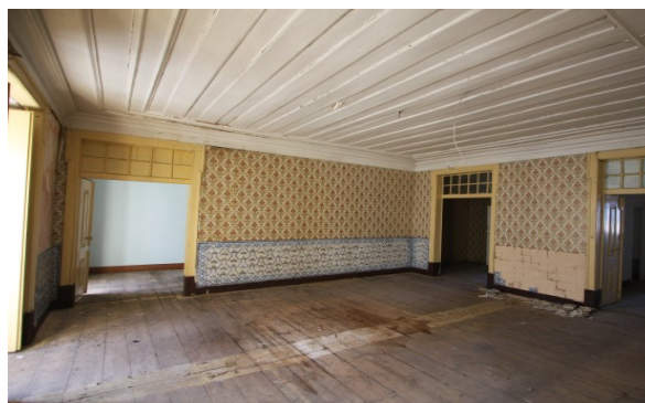
Figura 105. Terceiro andar; degradação do pavimento em madeira, ausência de azulejos, elementos em madeira degradado, com empolamento de tinta, teto degradado com empolamento de tinta e desprendimento de tábuas de madeira.
