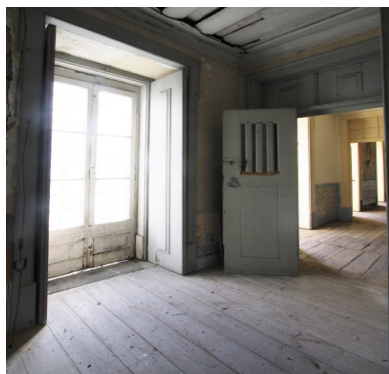
Figura 101. Terceiro andar; Degradação do pavimento em madeira, ausência de azulejos, degradação de paredes por empolamentos e desagregações, elementos em madeira degradados com empolamentos de tinta, teto em elevado estado de degradação devido à infiltrações junto à fachada.
