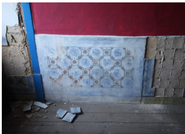
Figura 73. Primeiro andar; degradação do pavimento em madeira, ausência de azulejos, degradação de paredes por empolamentos e desagregação.
