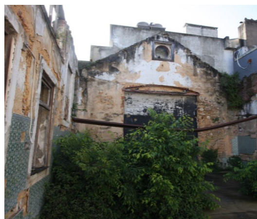
Figura 56. Logradouro: Edifícios em pré ruína.
