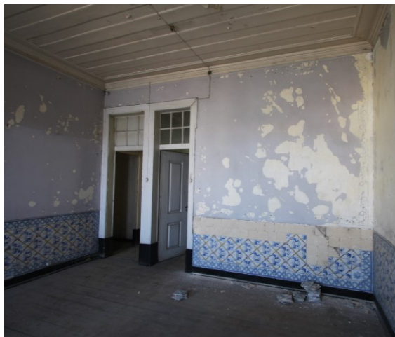
Figura 91. Segundo andar; degradação do pavimento em madeira, ausência de azulejos, degradação dos tetos com empolamentos de tinta.
