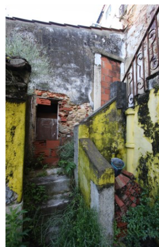
Figura 54. Logradouro: Presença de elementos com elevado nível de degradação.
