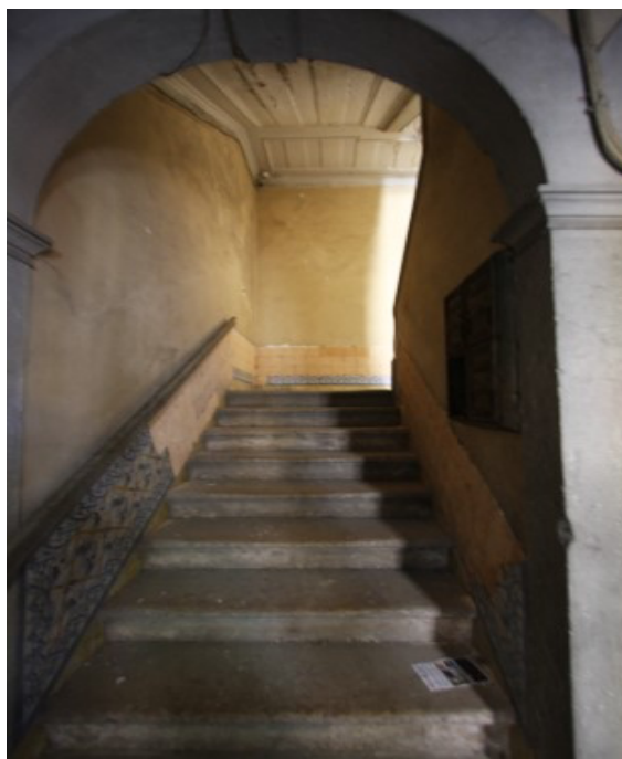
Figura 58. Escadas em pedra apresentando alguma degradação.
