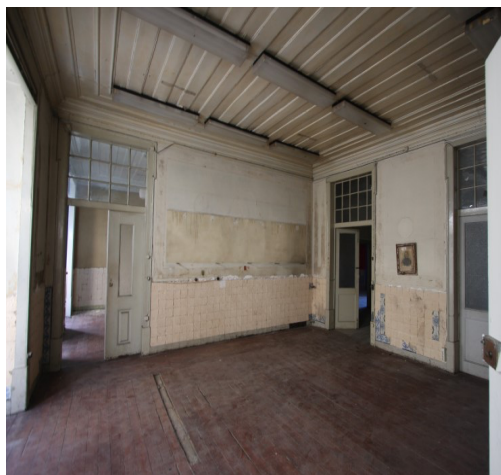
Figura 69. Primeiro andar; degradação de paredes apresentando empolamentos e desagregações; degradação do pavimento em madeira, ausência de azulejos nas paredes, perda pontual de rodapés, presença de humidade nas paredes e teto.
