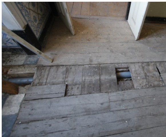
Figura 92. Degradação do pavimento em madeira.
