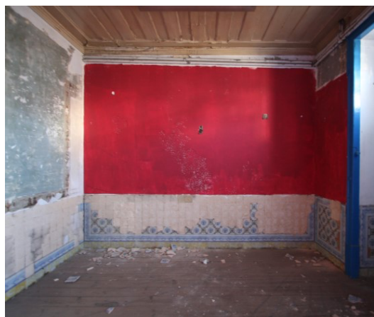
Figura 74. Primeiro andar; degradação do pavimento em madeira, ausência de azulejos, degradação de paredes por empolamentos e desagregação.
