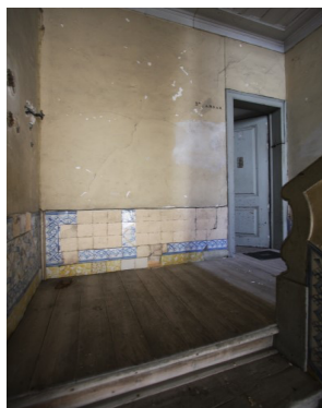
Figura 102. Terceiro andar; degradação do pavimento em madeira, ausência de azulejos, degradação de paredes por empolamentos e desagregações, elementos em madeira degradados com empolamentos de tinta, teto em elevado estado de degradação devido à infiltrações junto à fachada.
