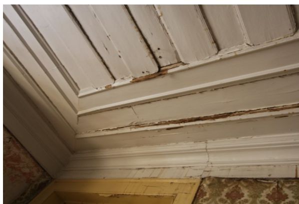
Figura 106. Terceiro andar; pormenor do teto degradado com empolamento da pintura.
