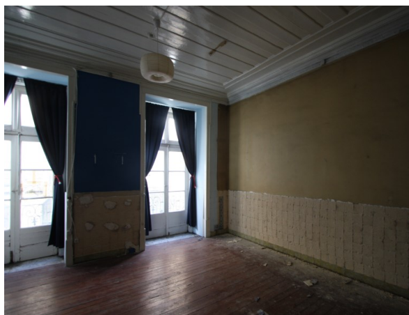
Figura 71. Primeiro andar; degradação do pavimento em madeira, ausência de azulejos nas paredes, perda pontual de rodapés, presença de humidade nas paredes e teto.
