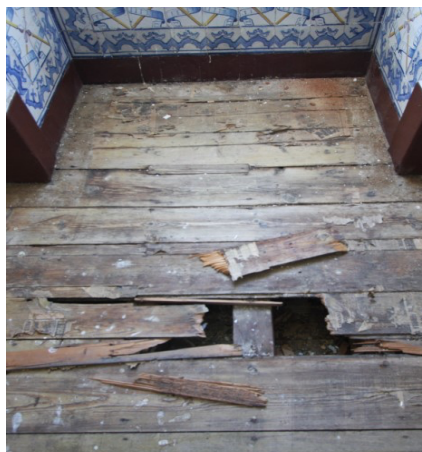
Figura 112. Terceiro andar; pormenor do pavimento vendo-se a degradação do soalho.
