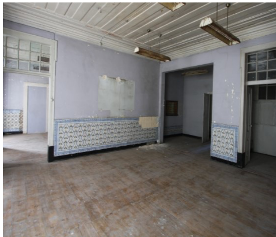
Figura 87. Segundo andar; degradação do pavimento em madeira, ausência de azulejos em zonas pontuais, degradação de paredes por empolamentos e desagregações.
