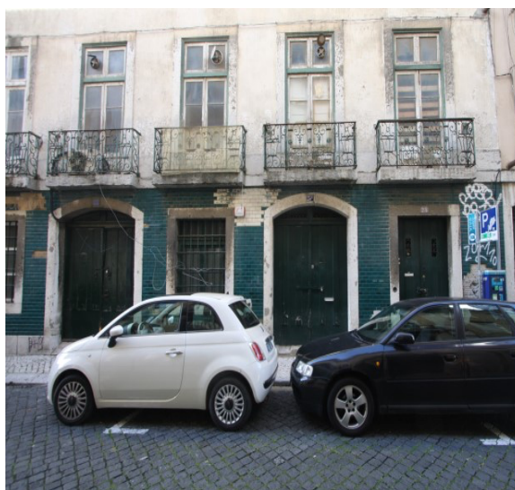
Figura 48. Presença de cabo de eletricidade que adulteram a imagem geral da fachada, cantarias danificadas e com presença de sujidade, caixilharia e vidros danificados.
