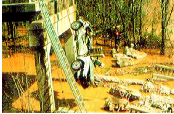
Figura 53 - Colapso da ponte sobre Hatchie (LPESA)
