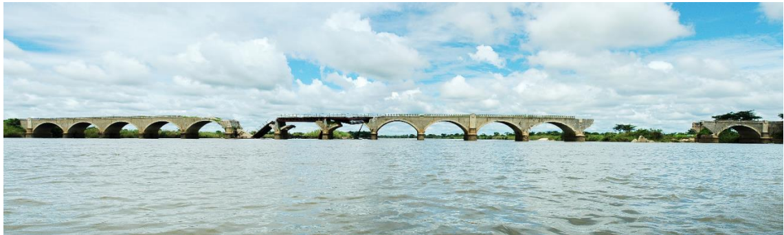
Figura 11 - Ponte sobre o rio Kwanza, em Cangandala destruída (Armando Rito Engenharia, S.A)
