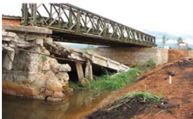
Figura 17 - Tramo destruído da ponte sobre o rio Caninda, com estrutura metálica provisória. (Conduril, s.d.)
