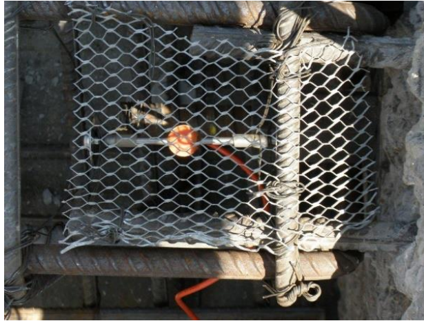
Figura 75 - Exemplo de um extensómetro de corda vibrante usado na monitorização da Ponte 4 de Abril (Santos L. , 2015)
