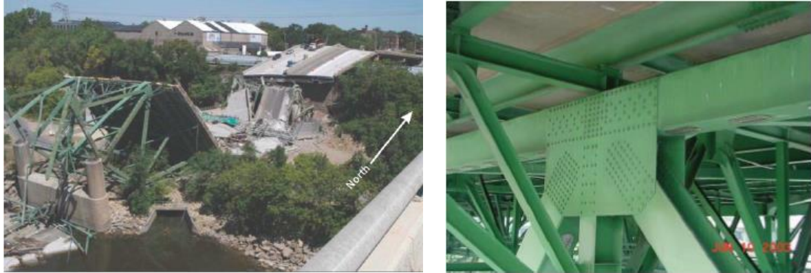
Figura 55 - (a) Ponte I-35 W Colapsada. (b) Exemplo de um nó da ponte I-35 W constituído por placas gusset. (National Transportation Safety Board, 2007)
