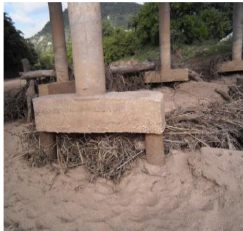
Figura 35 - Infraescavação nas fundações da ponte sobre o rio Caluála (Pericão, et al, 2013)
