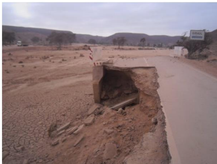
Figura 31 - Colapso da ponte sobre o rio Giraul (ISQ)
