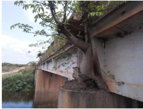
Figura 34 - Vegetação sobre o pilar da ponte sobre o rio Lucala (Pericão, et al, 2013)
