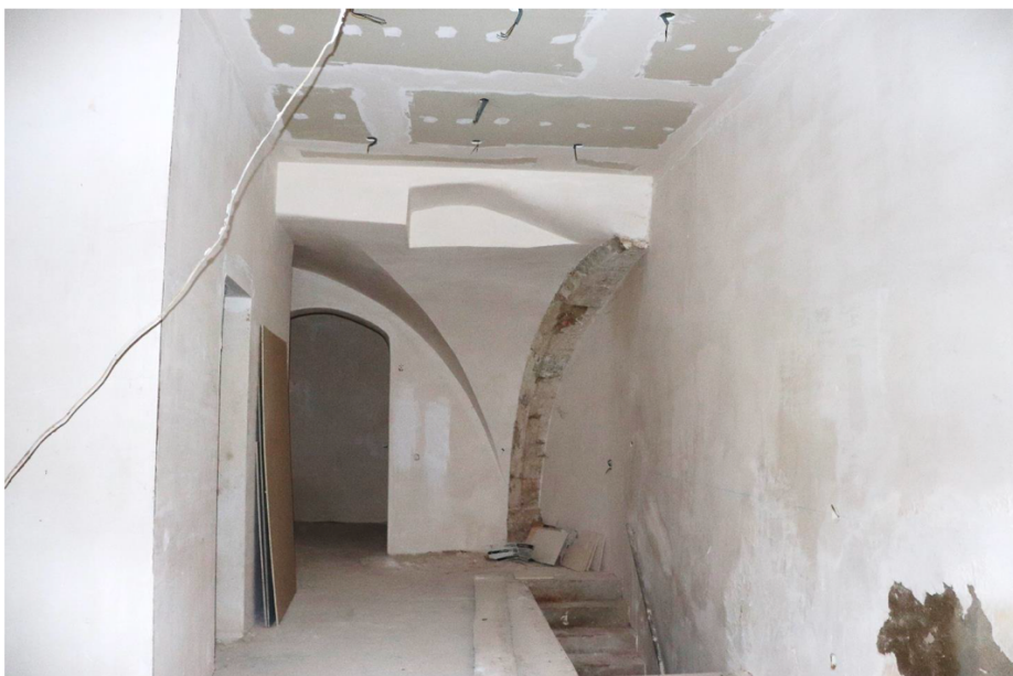
Figura 25 - Arco e abóbada da loja correspondente ao nº 3 da Rua Dom Antão de Almada, com obras não terminadas.
