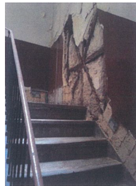
Figura 40. Edifício na Rua do Arsenal, 108; vista da parede de frontal da caixa de escadas antes das obras, evidenciando patologias devido a infiltrações (2014).
