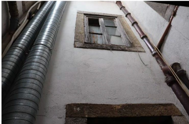
Figura 33 - Estado das cantarias das janelas do saguão sul
