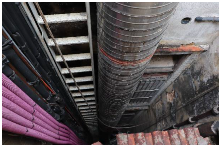
Figura 34 - Estado do saguão norte
