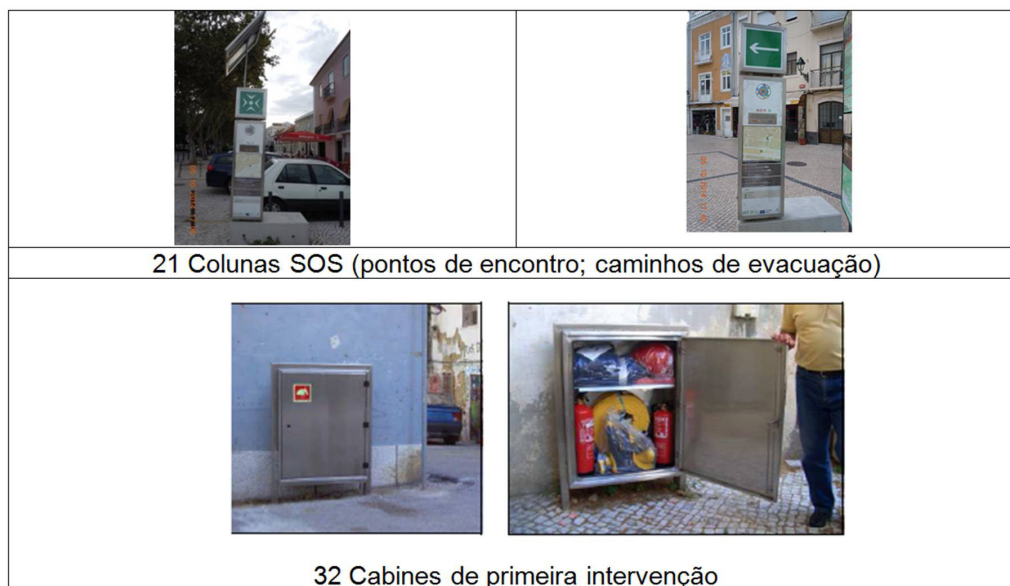
Figura 3: Plano Municipal de Emergência – Intervenção no Centro Histórico, Setúbal. Equipamentos e sinalética de emergência. Fonte: Acervo dos autores.
