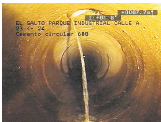
Figura 4 – Ligação indevida (Manvias Condutas, 2014)
