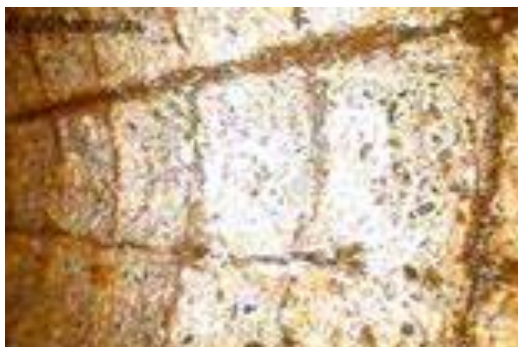
Figura 9 – Corrosão acentuada com exposição de armadura (Manvias Condutas, 2014)
