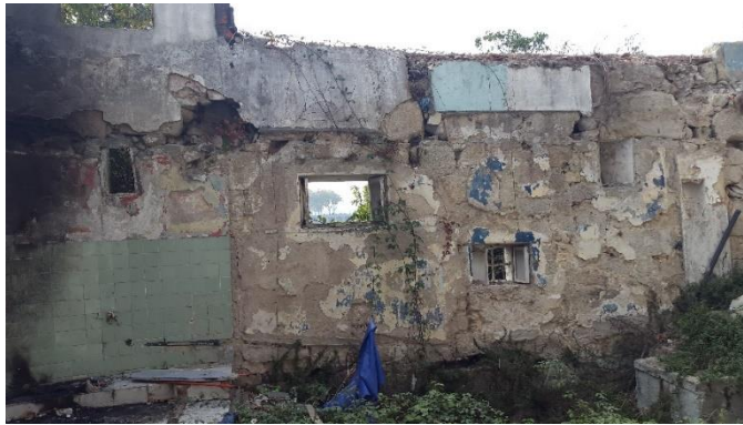
Figura 10|Fotografia do interior da pré-existência em estado de ruína
