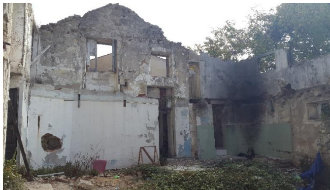
Figura 11|Fotografia do interior da pré-existência em estado de ruína
