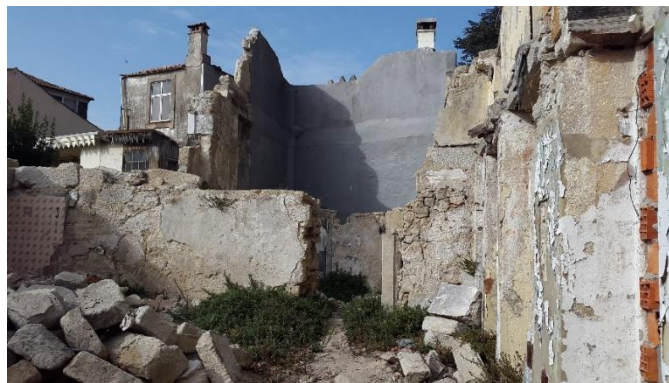
Figura 13|Fotografia do interior da pré-existência em estado de ruína
