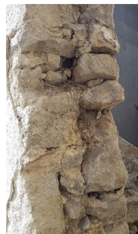
Figura 15| Fotografia de uma parede da ruína
