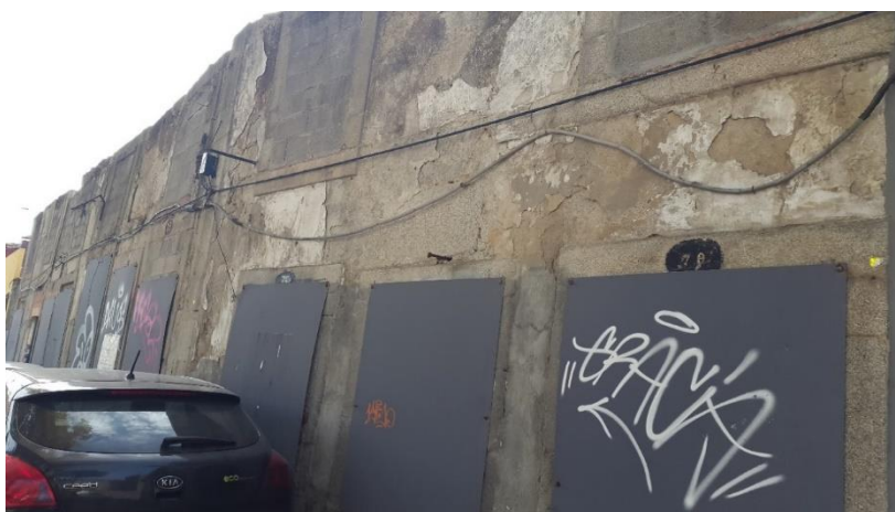
Figura 14| Fotografia do alçado norte da pré-existência em estado de ruína
