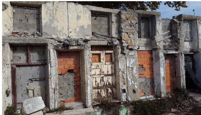
Figura 12|Fotografia do interior da pré-existência em estado de ruína
