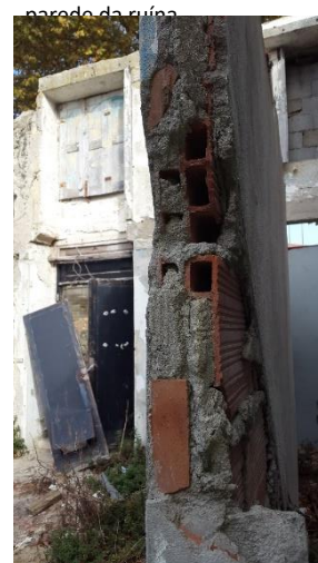
Figura 16| Fotografia de uma parede da ruína
