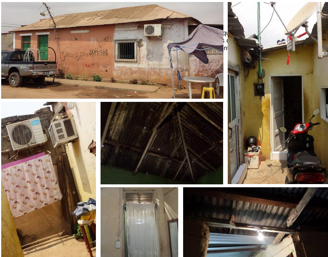
Fig. 51 – Habitação 2, em cima a foto do exterior, em que podemos notar que a porta e uma das janelas foram fechadas, no caso, este corpo principal agora compreende duas habitações distintas. Em baixo e no centro, as fotos do estado da cobertura e da porta de acesso a sala. Dos lados, fotos do quintal quase inexistente atualmente, sendo agora mais um beco do que propriamente um quintal, mas ainda assim mantém-se como o lugar de eleição para o desenvolvimento das atividades domésticas diárias. Vale notar também a existência de vários anexos, alugados à terceiros, e a forte presença de aparelhos de ar condicionado.
