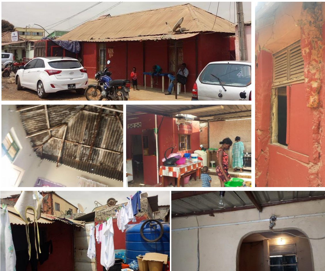
Fig. 50 – Habitação 1, em cima a foto do exterior da habitação, no meio do lado esquerdo a foto do estado atual da cobertura, ao centro a foto da família nas suas lides diárias e dos anexos localizados no quintal. Do lado direito a foto do pormenor da janela. Em baixo do lado esquerdo mais uma foto do quintal e do lado direito do interior da habitação.
