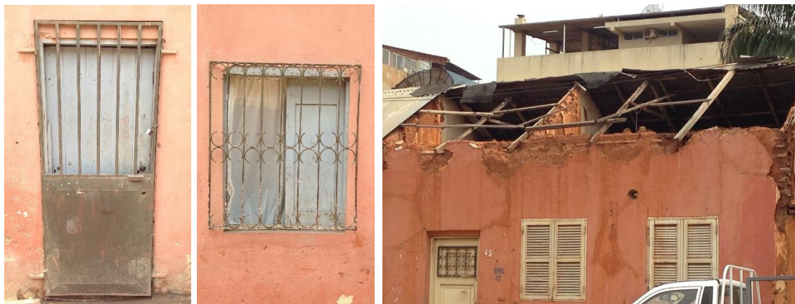
Fig. 55 – Pormenor das janelas e portas com grades, e da estrutura de um edifício que se encontra muito degradado.
