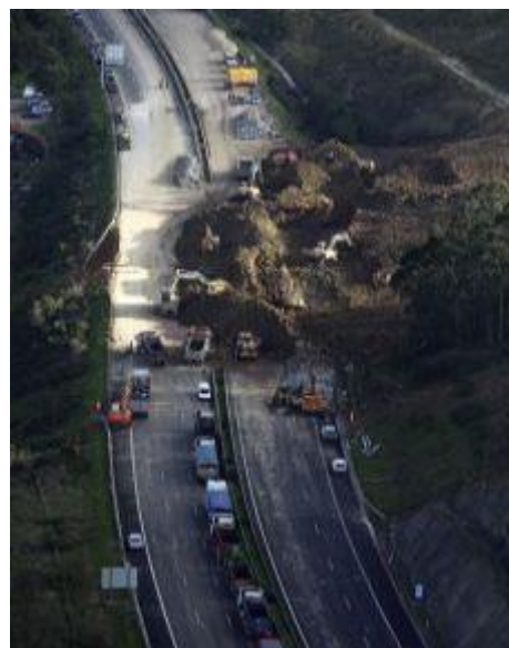
Figura 18 - Deslizamento de vertentes na CREL (Destak, 2018)
