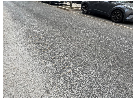
Figura 2.5 – Pavimento com patologias
