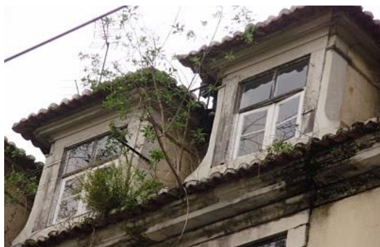
Figura 36– Ervas nos Telhados
