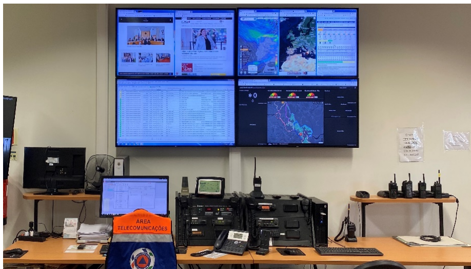
Figura 15 - Equipamentos de telecomunicações e informática
