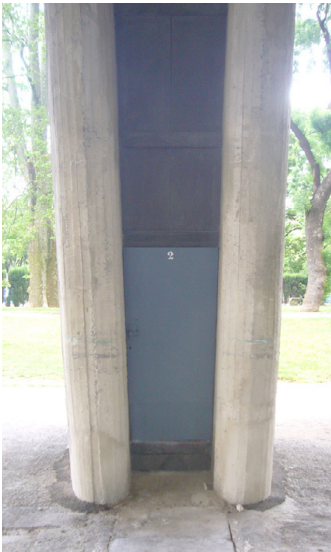
Figura 49. Pilar exterior e pormenor do acesso aos equipamentos instalados no interior.
