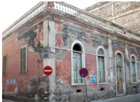
Fig. 27- Estado degradado de um edifício construído na época colonial, Cidade da Praia, Santiago (Inocêncio, 2012, p. 23).
