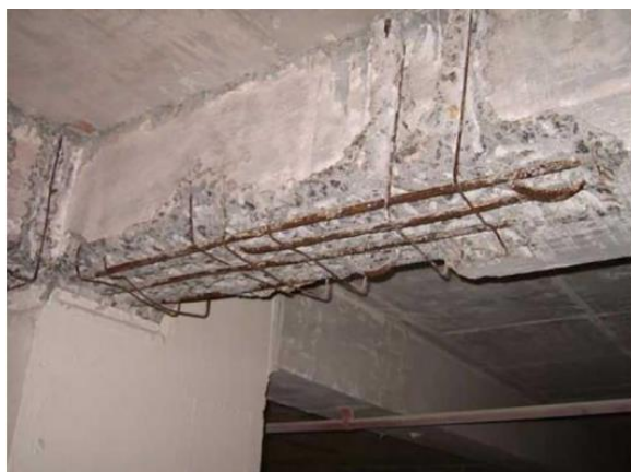
Figura 16 - Desagregação do betão em viga. (Araldi, 2013)
