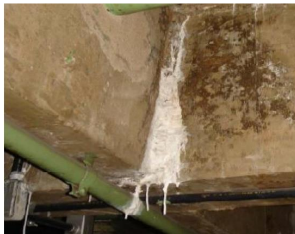
Figura 22 – Eflorescência (Santos e Filho, 2008)
