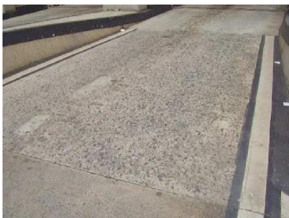
Figura 17 - Desgaste superficial por abrasão em pavimento de betão (Aguiar, 2006)
