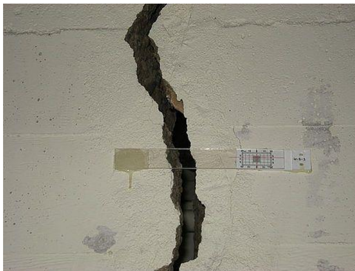
Figura 7 - Rachadura em estruturas de betão armado (Flausino, 2017)
