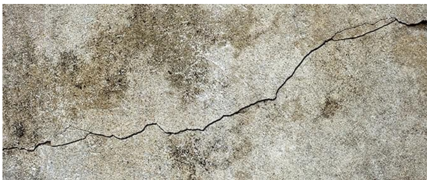
Figura 5 - Fissuras em estruturas de betão armado (AECweb.com)
