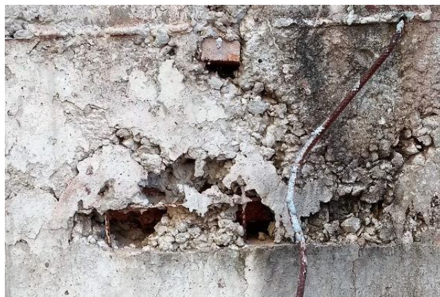
Figura 15 - Elemento em betão armado com segregação (Ecivilnet.com)
