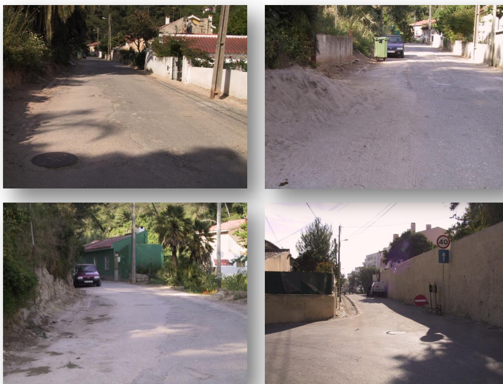
Figura 61 – Falta de alternativas de acesso aos moradores residentes entre as câmaras de visita CD0267,00 e CD 0380,00 - Rua do Vale de S. Rita – Caso de Estudo 1
