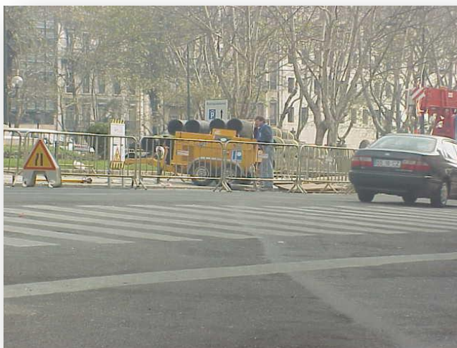
Figura 37 – Pormenor do poço de tracção da tubagem sendo visível o guincho de 10 toneladas utilizado no processo de inserção (MANVIA, 2006)
