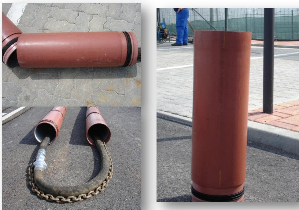
Figura 75 – Tubos modulares em polipropileno do fabricante EGEPLAST – Caso de Estudo 2
