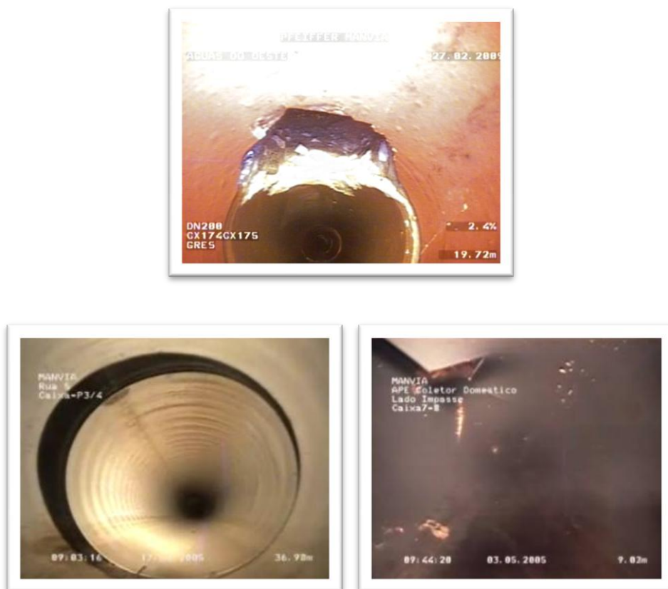
Figura 5 – Exemplos de patologias pontuais (MANVIA, 2005)
