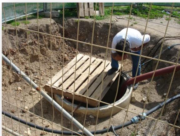
Figura 78 – «By-pass» instalado – Caso de Estudo 2
