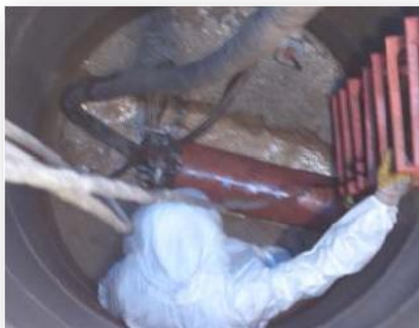
Figura 83 – Toda a obra foi efectuada utilizando sempre as caixas de visita existentes – Caso de Estudo 2
