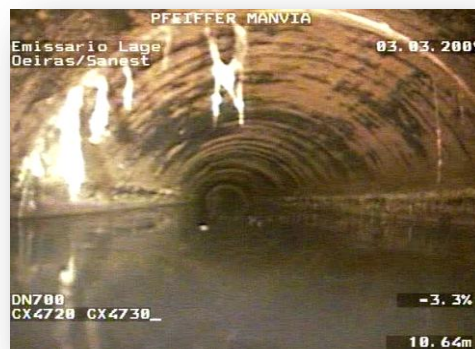
Figura 30 – Pendentes contrárias ao escoamento (PFEIFFER MANVIA, 2009)
