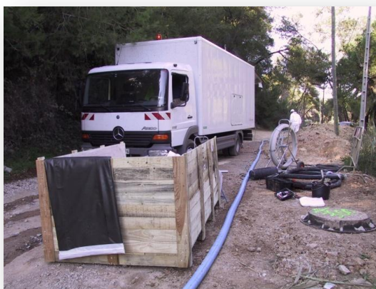
Figura 63 – Troço de manga provido dentro da caixa de madeira – Caso de Estudo 1
