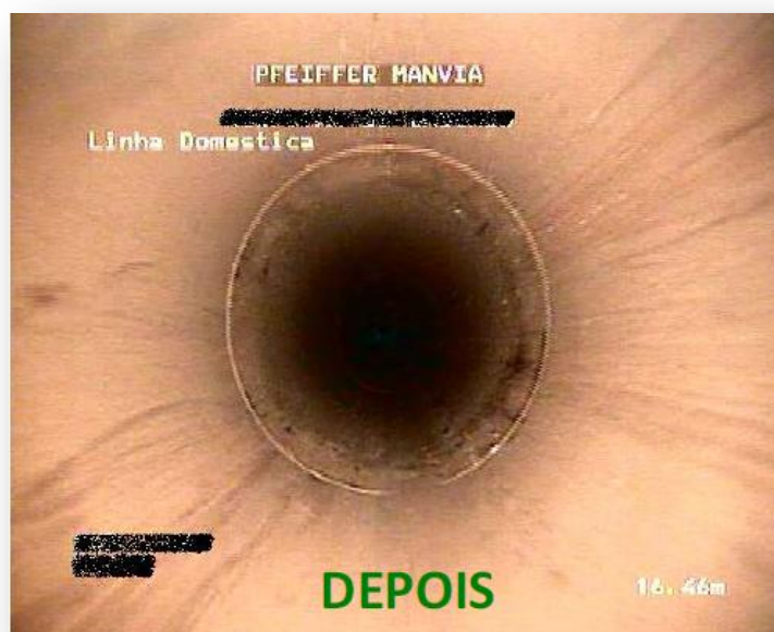
Figura 84 – Colector reabilitado pela técnica de entubamento por rebentamento com tubos modulares (MANVIA, 2010) – Caso de Estudo 2
