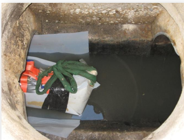
Figura 24 – Manga instalada dentro da caixa imediatamente após a tracção para interior do troço. É visível um filme de polietileno que se coloca dentro da tubagem para prevenir danos na superfície da manga (MANVIA, 2007)
