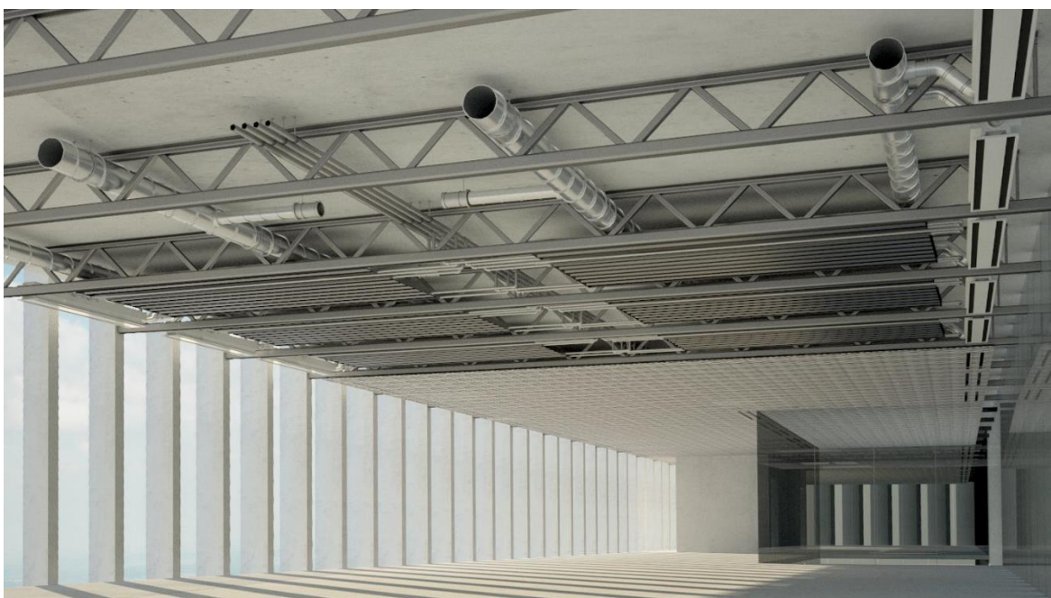
Figura 43: Sede da EDP – Vista interior das infraestrutura
