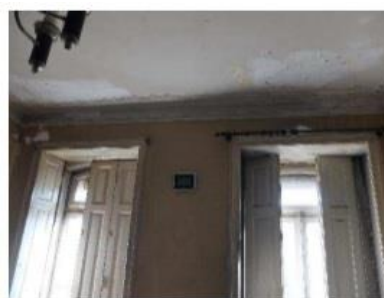
Figura 27: Humidade em parede exterior (fachada principal) de alvenaria ao nível do Piso 02.
