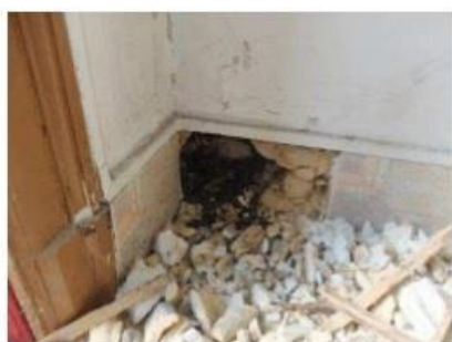
Figura 31: Degradação material intensa de parede de tabique simples do Piso 01.
