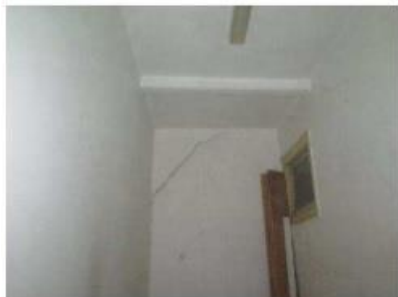
Figura 29: Fissuração diagonal em parede composta do tardo da caixa de escadas, ao nível do Piso 02.
