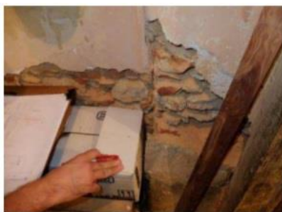
Figura 26: Humidade ascensional nas paredes de alvenaria do Piso 0.
