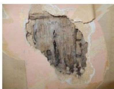
Figura 30: Degradação material intensa de parede de tabique simples do Piso 02.
