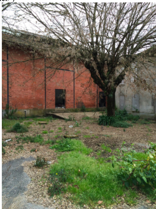
Figura 65- Materialidade da parede com tijolo na Fábrica do Ouro (fonte: Miranda, Fernando (2016))
