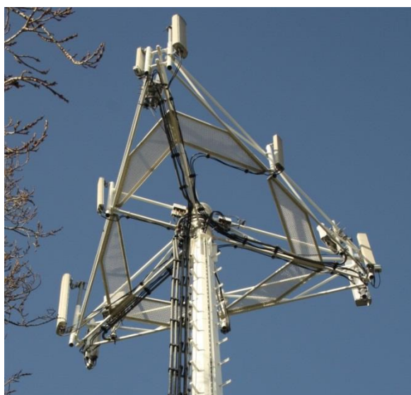
Figura 2.14 - Interface de antenas no topo de uma torre de telecomunicações.
