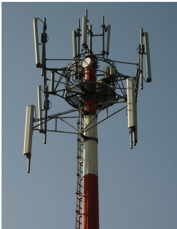
Figura 2.16 - Agrupamento de interfaces no topo de uma torre de telecomunicações, mostrando a complexidade possível nestes elementos.
