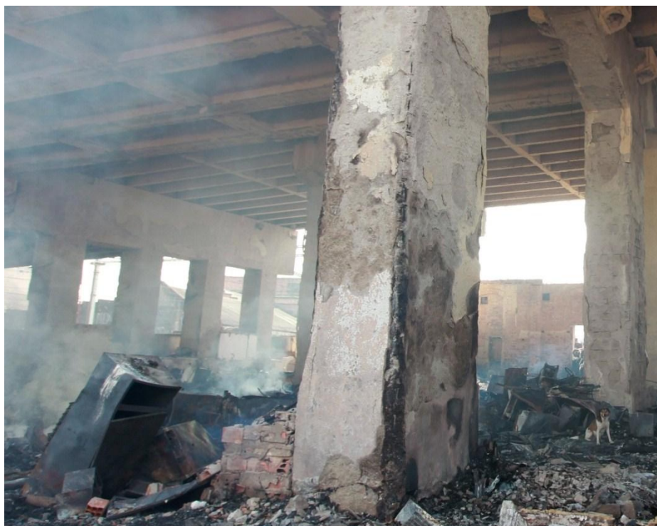
Figura 19 – Deterioração pela ação do fogo; noticias.uol.com.br
