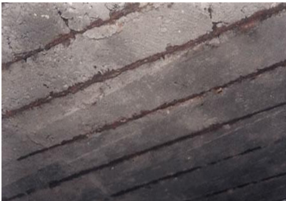
Figura 23 – Corrosão das armaduras; http://amigonerd.net
