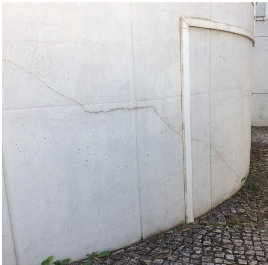
Figura 60 – Fissura na fachada nascente do módulo ‘A’ , 2013
