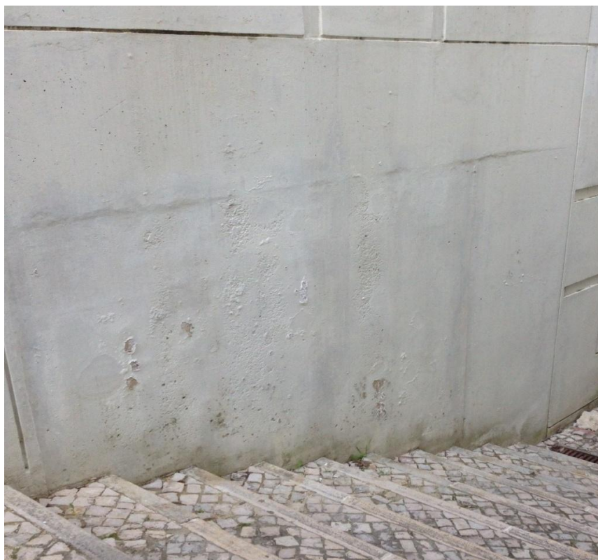
Figura 63 – Presença de eflorescências e descasque de pintura no módulo ‘C’ , 2013
