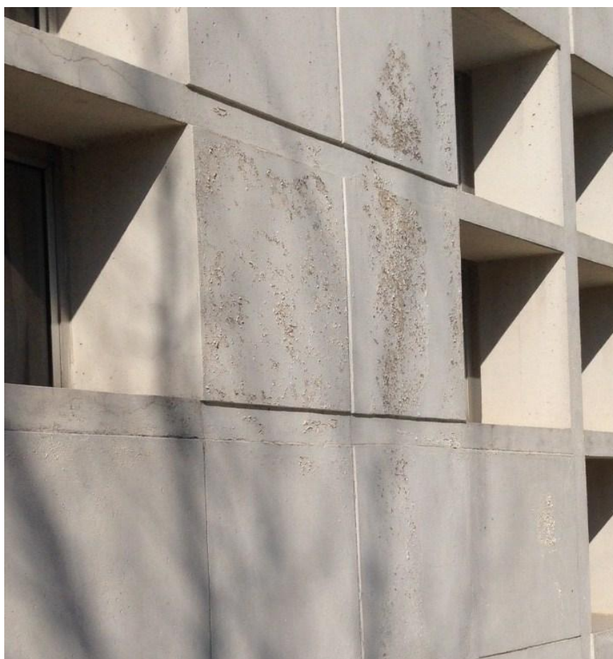
Figura 59 – Descasque da pintura na fachada sul do módulo ‘A’ , 2013
