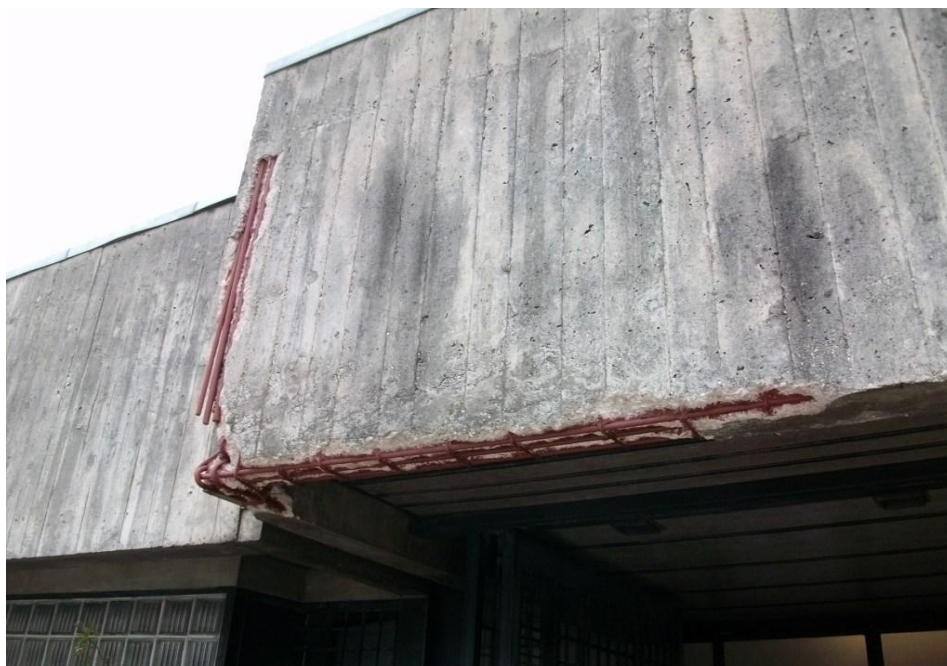
Figura 8 – Igreja dos Olivais, corrosão das armaduras com destacamento do betão, 2013
