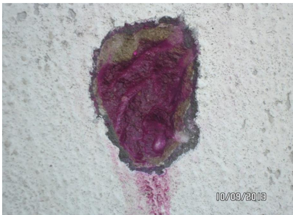
Figura 47 – Ensaio de fenolftaleína em obra, 2013
