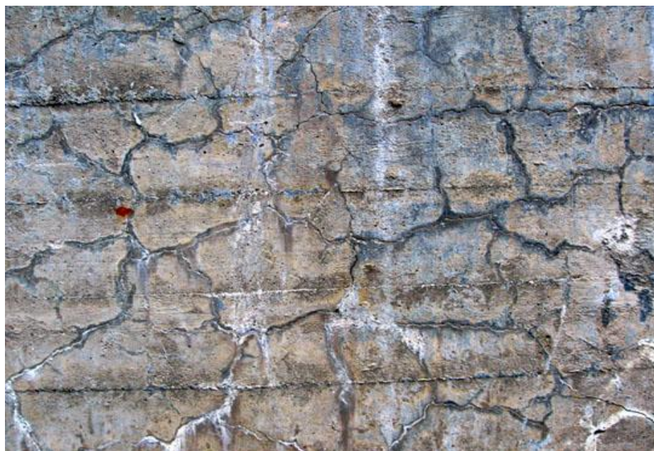
Figura 16 – Fendilhação devida à retração do betão; http://www.engenhariacivil.com
