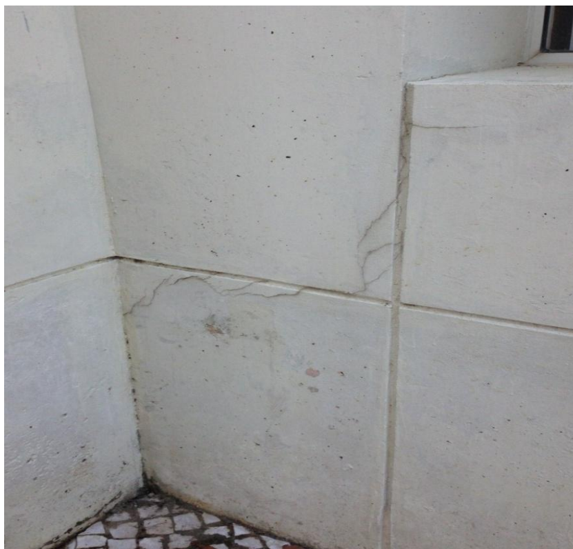
Figura 67 – Fissura reincidente e risco de delaminação do betão no módulo ‘D’ , 2013
