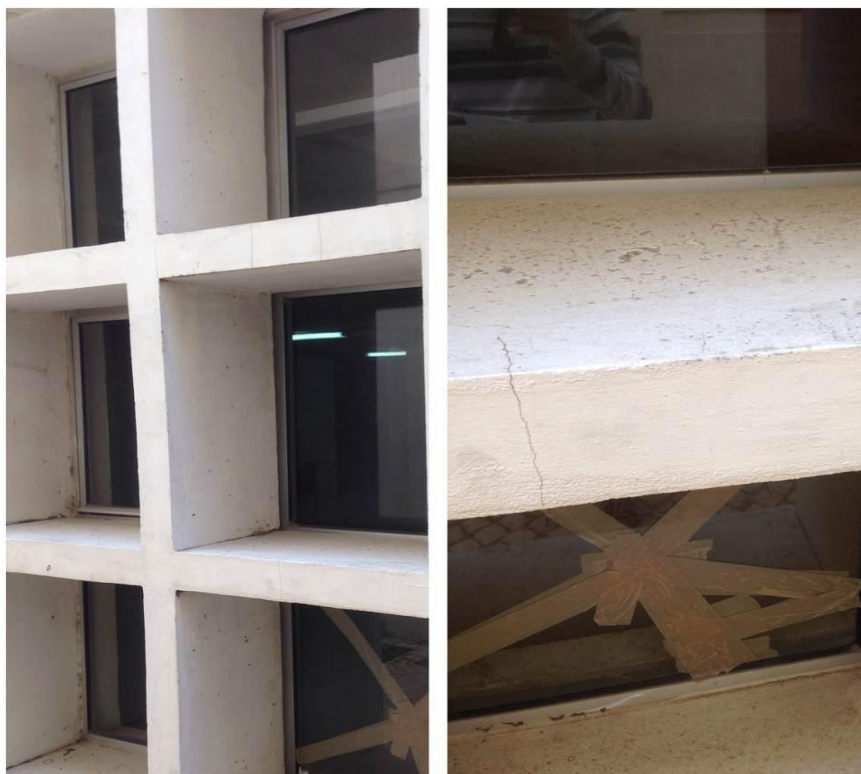
Figura 68 e 69 – Fissuras nos elementos verticais das janelas no módulo ‘E’ , 2013
