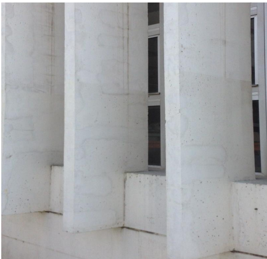
Figura 70 – Fissuras horizontais e manchas nos elementos verticais de fachada no módulo ‘E’ , 2013
