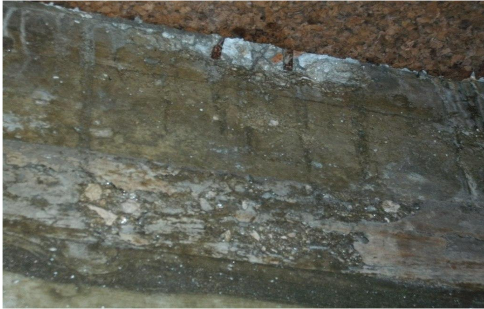
Figura 9 – Igreja dos Olivais, eflorescências devidas à carbonatação na superfície do betão, 2013
