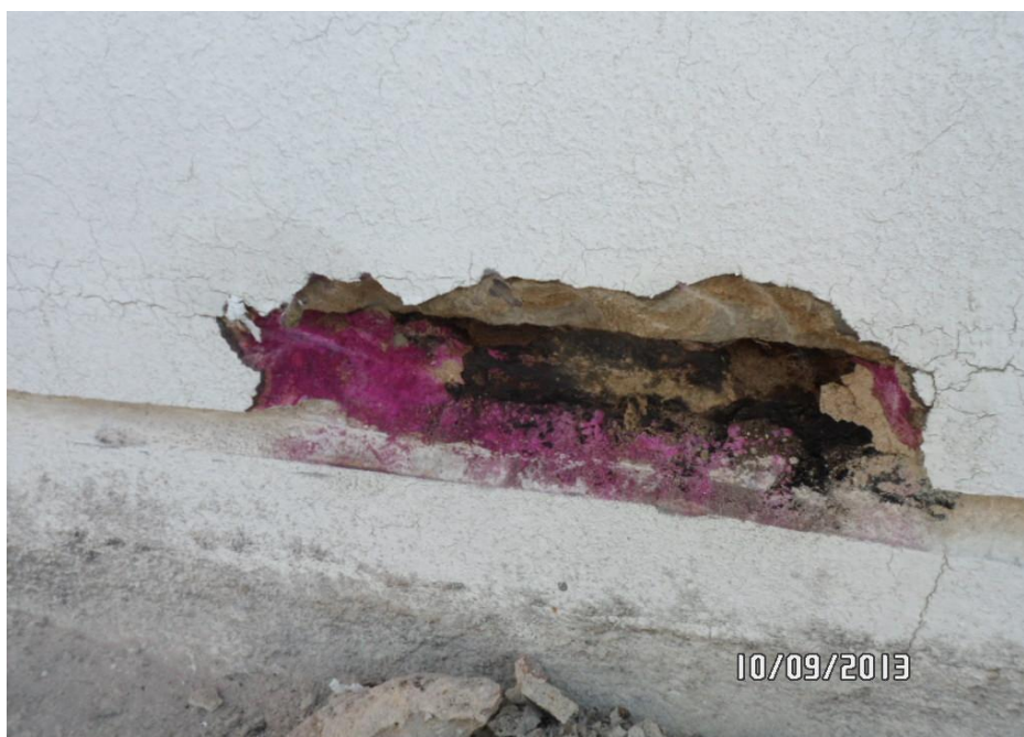
Figura 25 – Profundidade da carbonatação com recurso à fenolftaleína;
