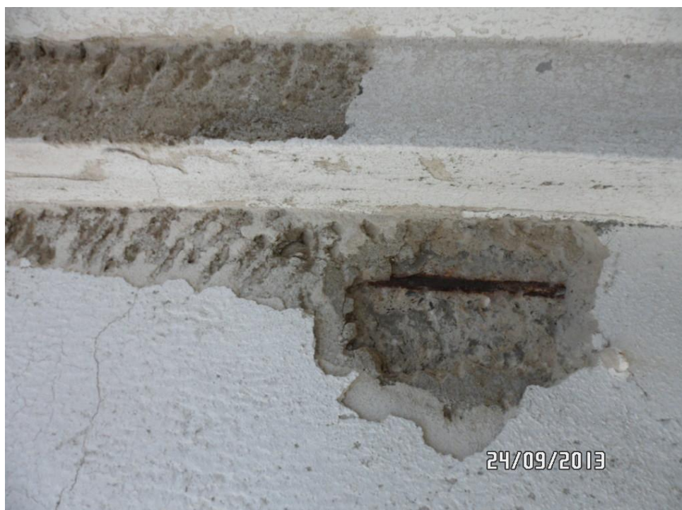
Figura 49 – Pontos de corrosão de armaduras, 2013
