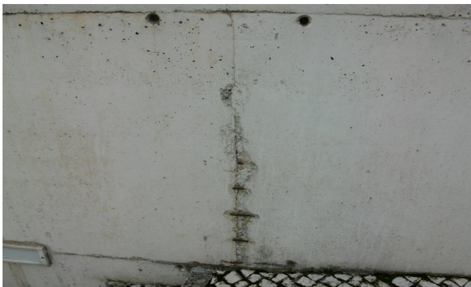
Figura 5 – ISCTE, Corrosão das armaduras, 2013
