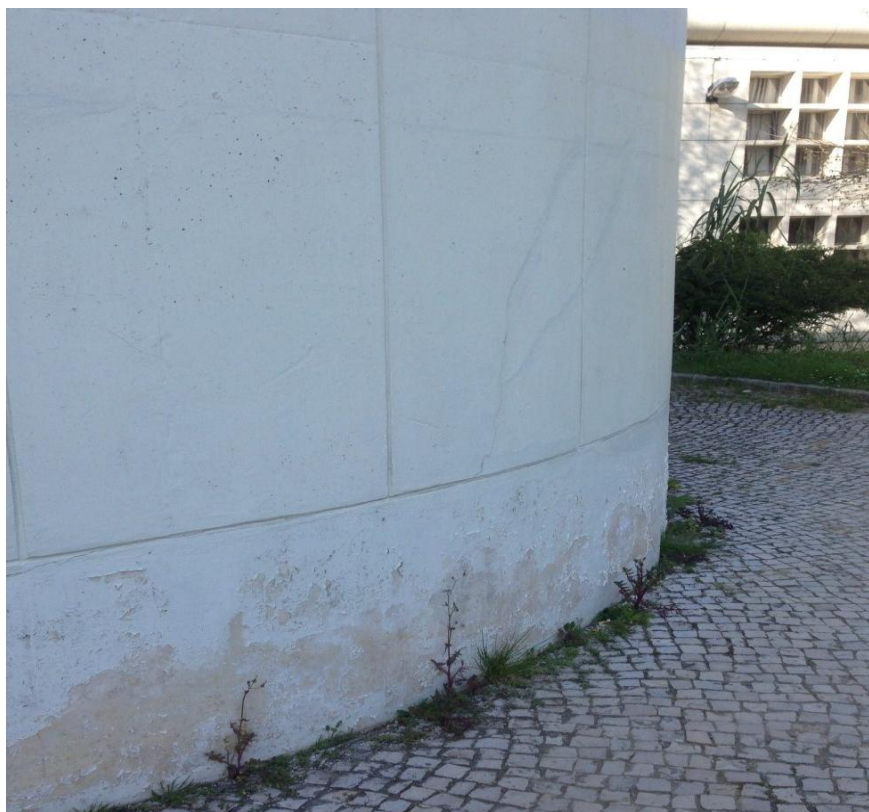
Figura 61 – Descasque da pintura e fissura reincidente na fachada nascente do módulo ‘B’ , 2013
