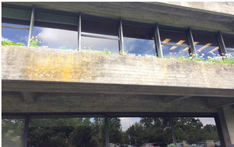
Figura 2 – Ataque biológico na superfície de betão aparente do edifício Gulbenkian, 2013
