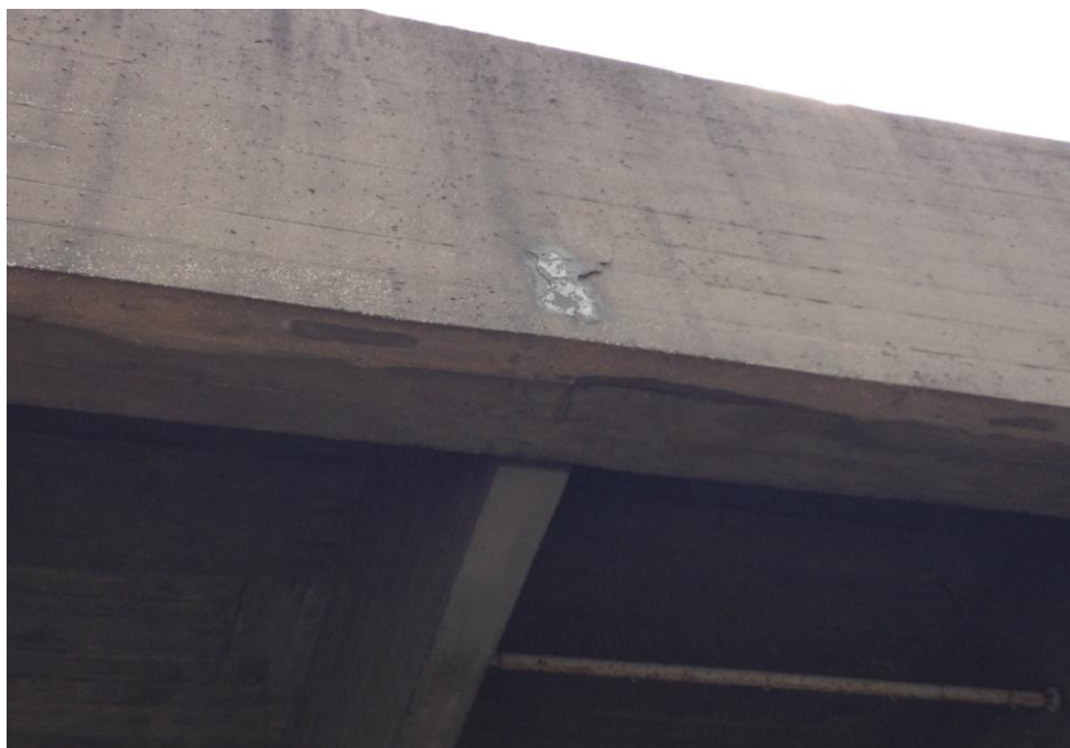
Figura 3 – Destacamento e eflorescências do betão no edifício Gulbenkian, 2013
