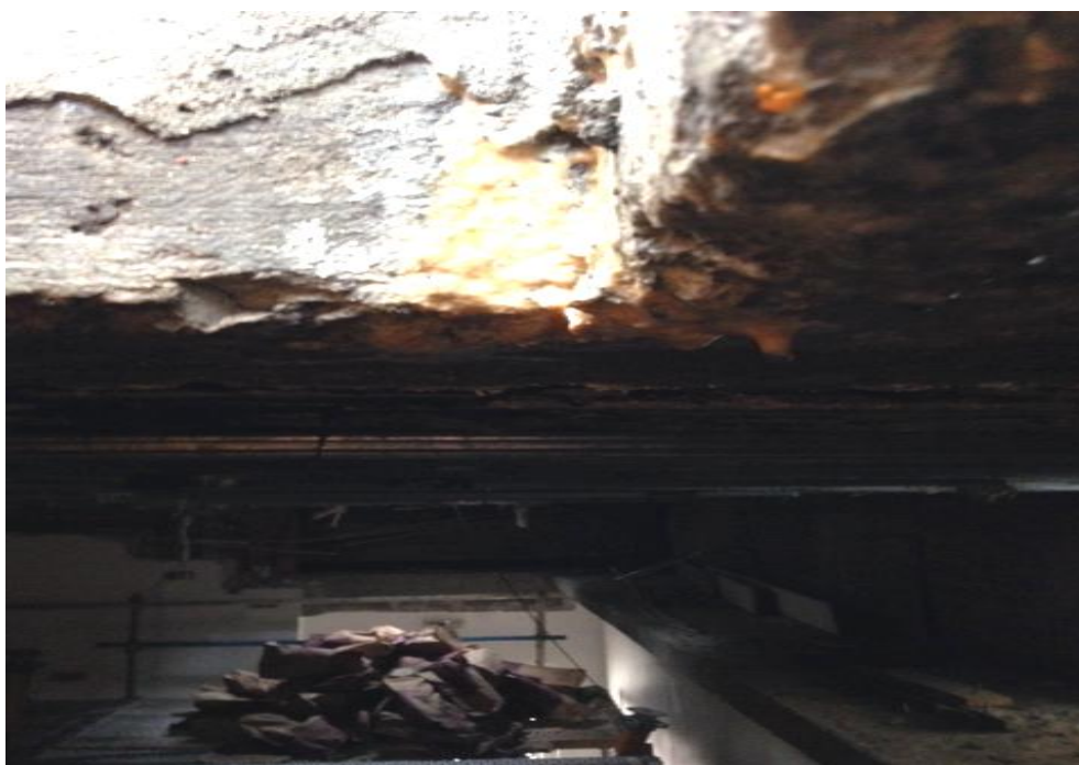
Figura 44 – Laje deteriorada por acumulação de humidade na zona da conduta de ar condicionado, 2013
