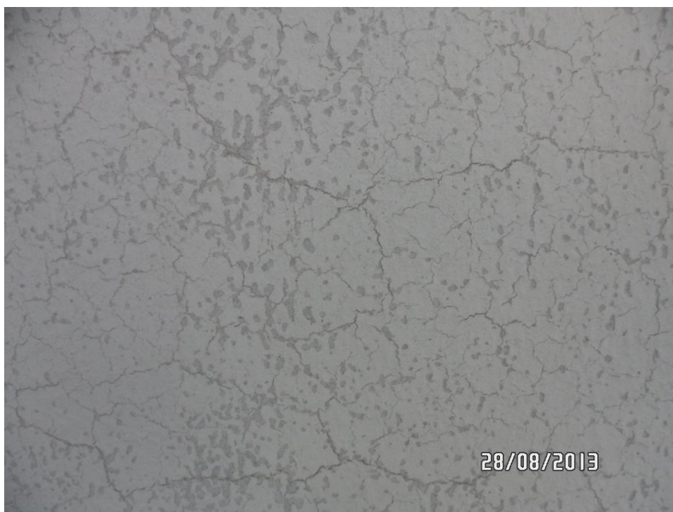
Figura 46 – Fissuração presente nas fachadas, 2013
