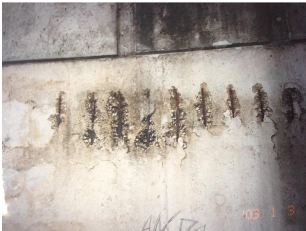
Figura 56 – Destacamento do betão e corrosão de armaduras nas fachadas, 2003
