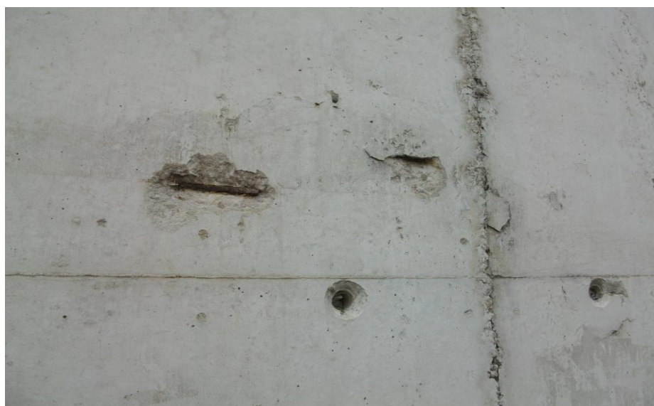
Figura 6 – ISCTE, Descasque e delaminação do betão, 2013
