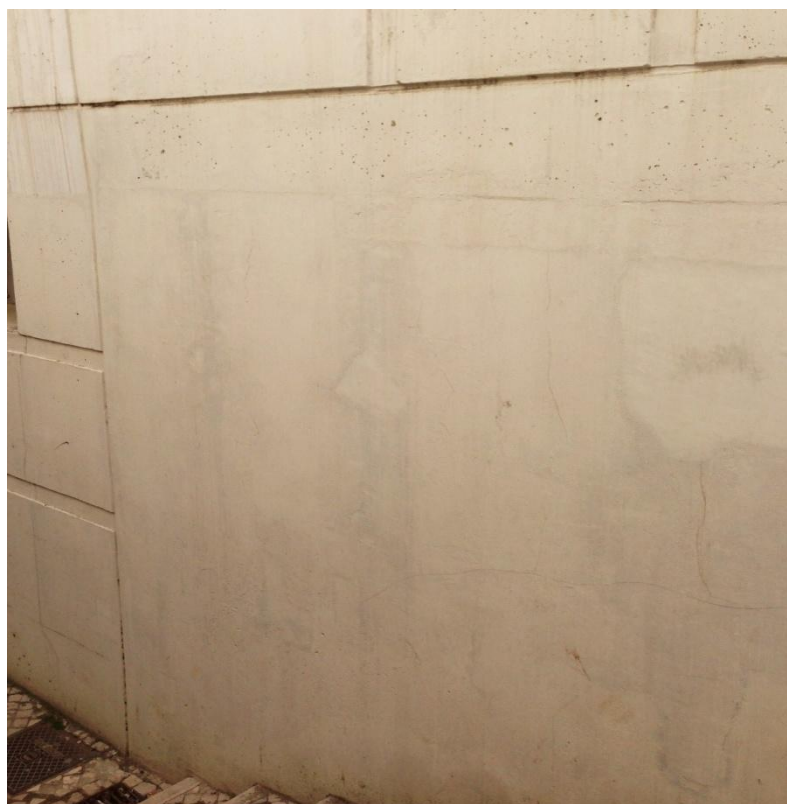
Figura 66 – Fissuração superficial e perceção das áreas de intervenção em 2004 ‘D’ , 2013
