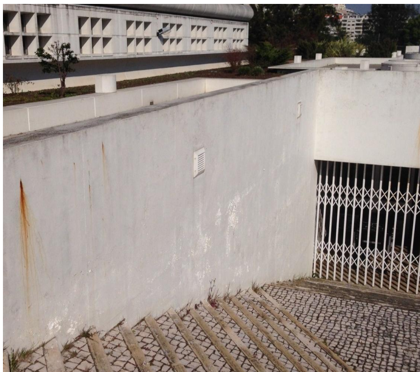
Figura 64 – Pontos de corrosão e descasque de pintura nas escadas interiores do módulo ‘C’ , 2013
