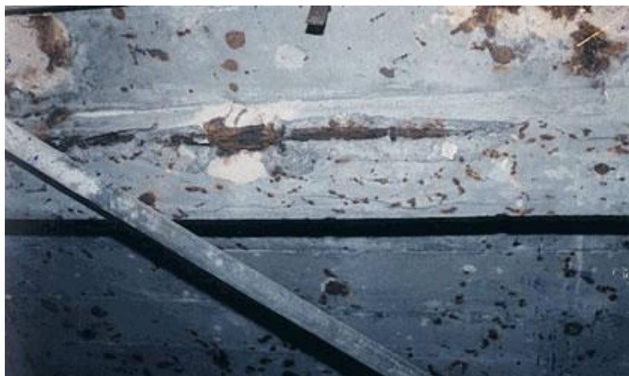
Figura 26 – Manchas de ferrugem, fissuração alinhada com a armadura e delaminação do betão; http://amigonerd.net
