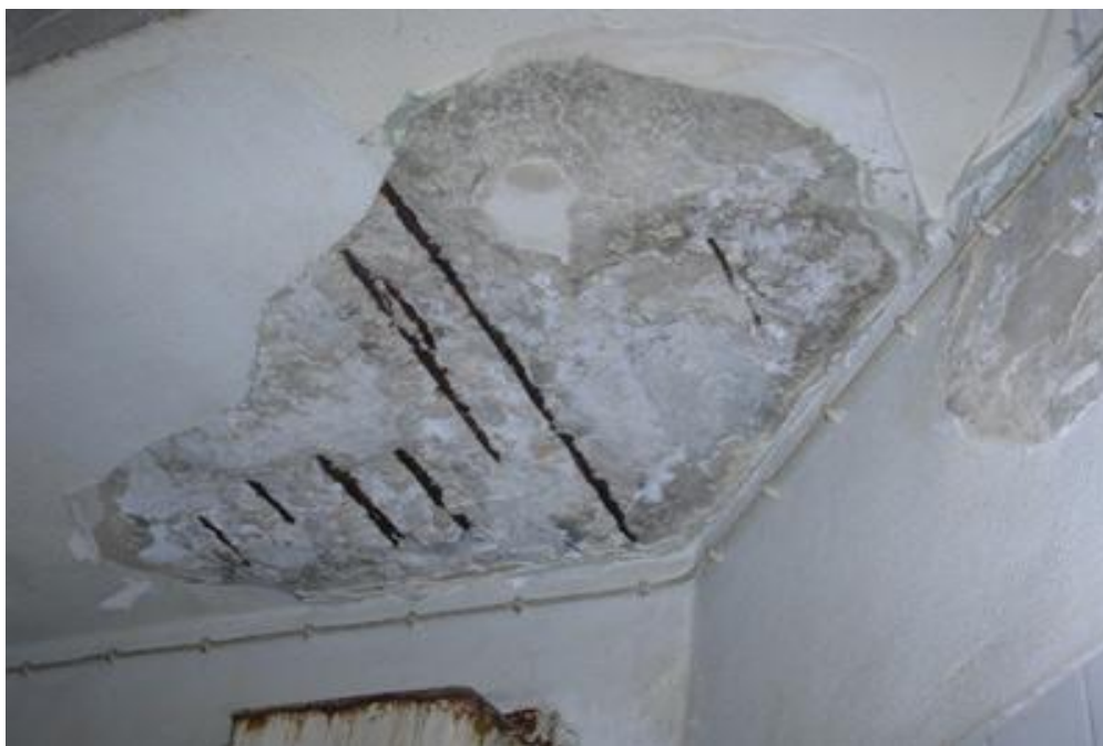
Figura 24 – Delaminação do betão por corrosão das armaduras
