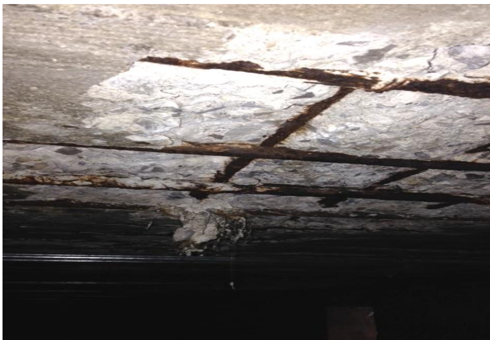
Figura 43 – Laje com corrosão de armaduras e delaminação do betão, 2013
