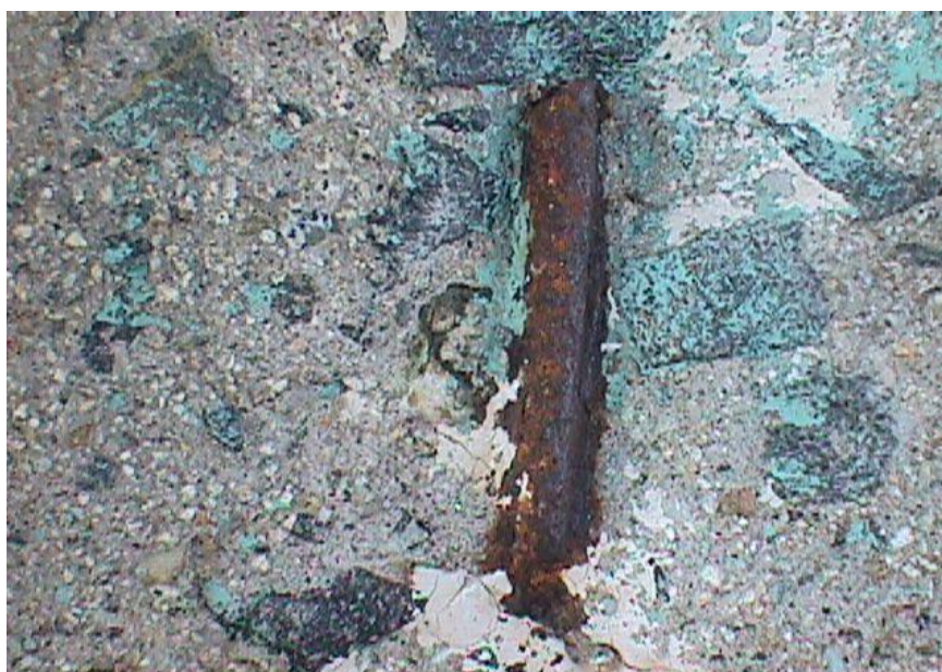
Figura 21 – Corrosão por ataque de sulfatos; www.arqhys.com
