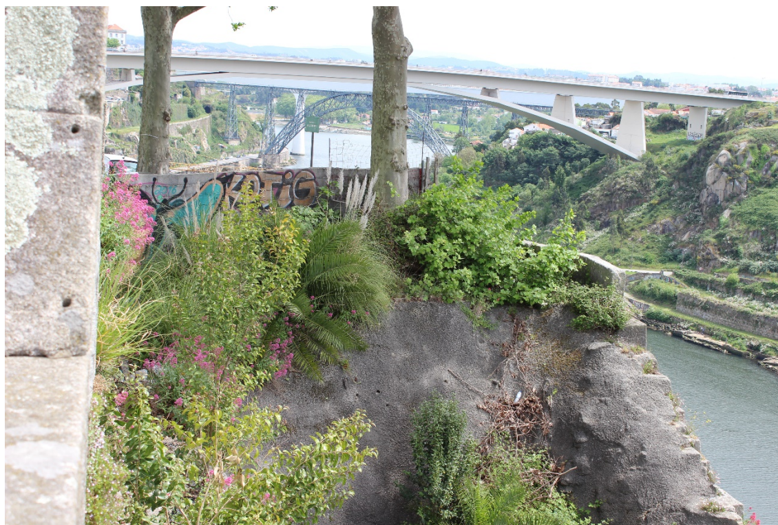
Fig. 16. Rua Passeio das Fontainhas após o desabamento.
