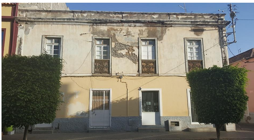
Figura 34 - Edifício em mau estado de conservação. (Fotografia do autor. 2016).
