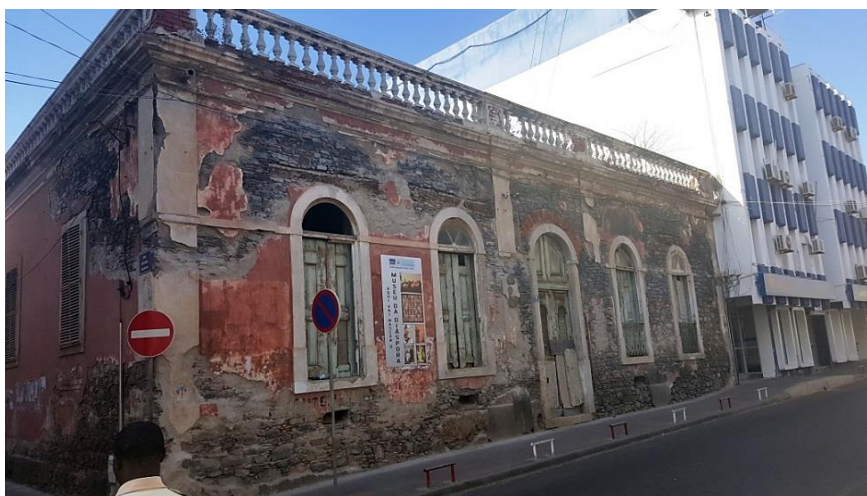
Figura 35 - Edifício em situação de pré ruína. (Fotografia do autor 2016).
