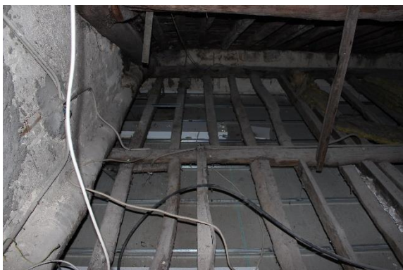
Fig. 60 – Estrutura de Madeira Deficiente
