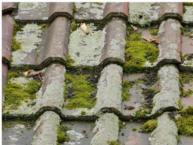
Fig. 26 – Musgo e detritos na telha
