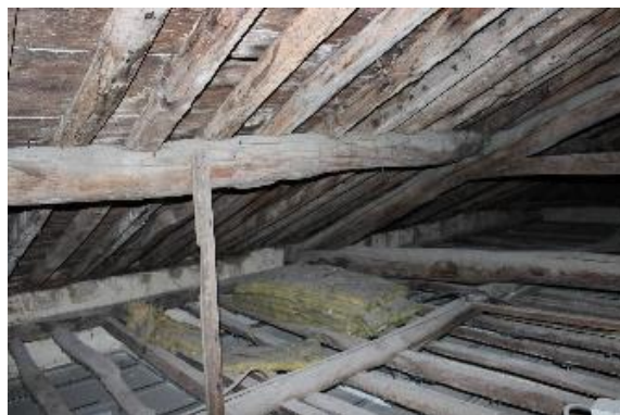
Fig. 59 – Insuficiência de Isolamento Térmico
