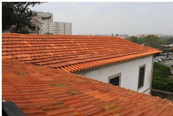
Fig. 61 – Revestimento Cerâmico com musgo
