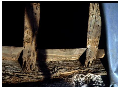
Fig. 34 – Degradação da Madeira – Infiltrações
