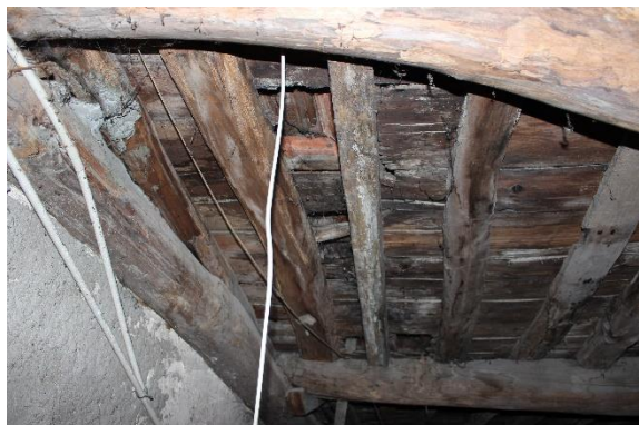
Fig. 58 - Degradação da estrutura – Infiltração
