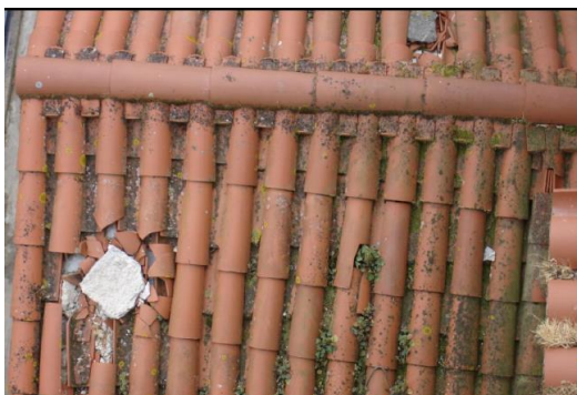
Fig. 41 – Anomalias por falta de manutenção
