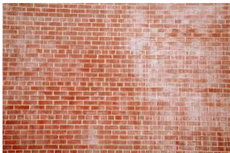
1. Exemplo de eflorescência numa parede de tijolo.
