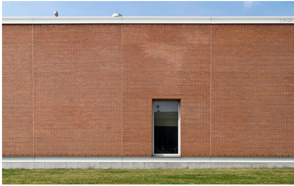
15. Fabrica de moveis Vitra, exemplo de junta de dilatação peridioptica
