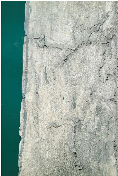
F 6 - Fendilhação oblíqua no cunhal em pedra Fonte: Autora (2017)
