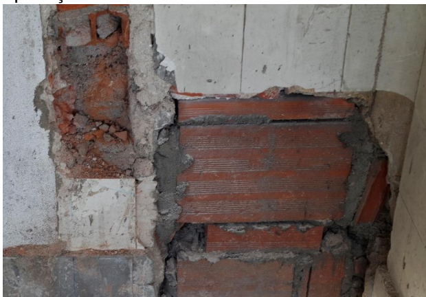
Fig. 23 - Parede com desprendimento parcial Foto da Autora
