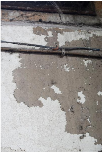
I 14 - Empolamento e destacamento da pintura Fonte: Autora (2017)
