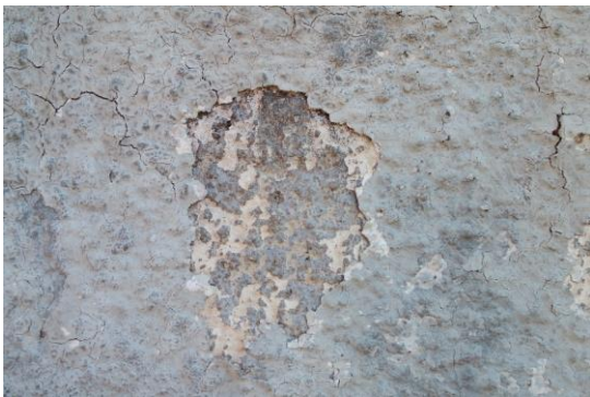
F 15 - Destacamento do revestimento de parede Filmes negros Fonte: Autora (2017)
