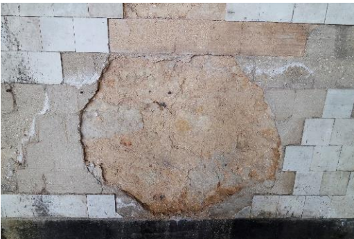
I 8 -Destacamento de rebocos e do revestimento azulejar Fonte: Autora (2017)
