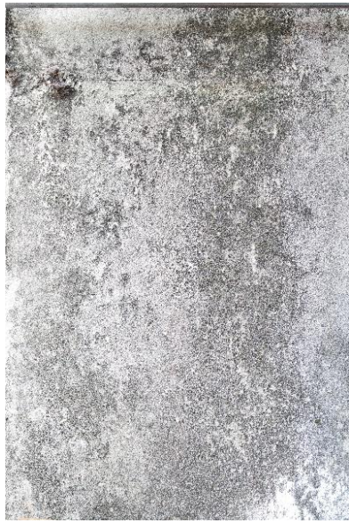
F 8 - Eflorescência em parede Fonte: Autora (2017)
