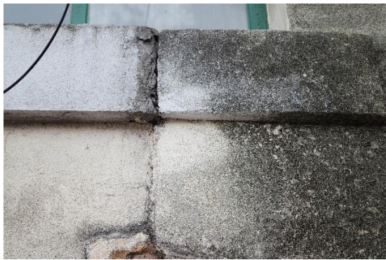
F 3 - Fendilhação na cantaria e presença de eflorescência Fonte: Autora (2017)
