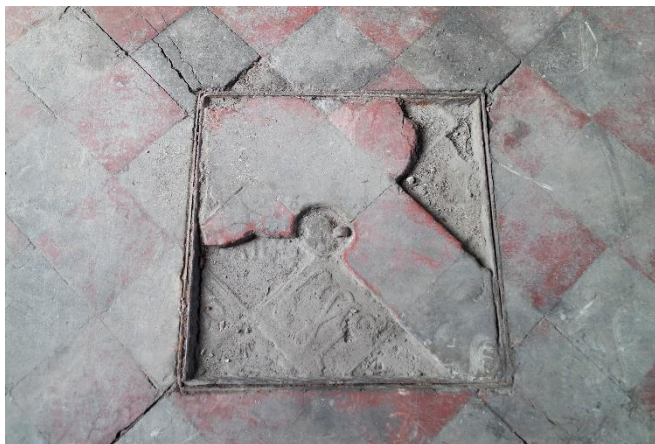
Fig. 25 - Pavimento de mosaico hidráulico fraturado e com fendilhação Foto da Autora
