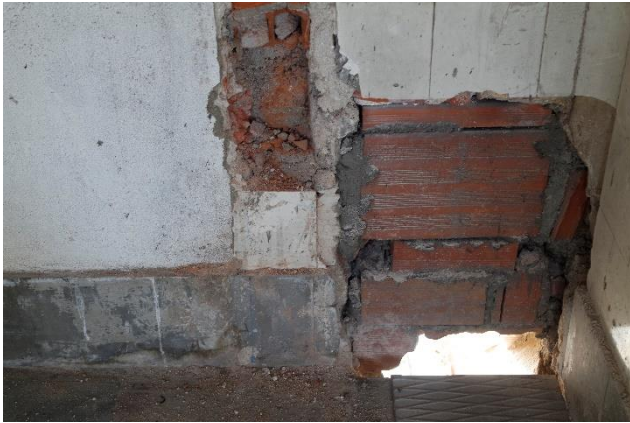
I 11 - Desagregação do revestimento da parede e área modificada Fonte: Autora (2017)
