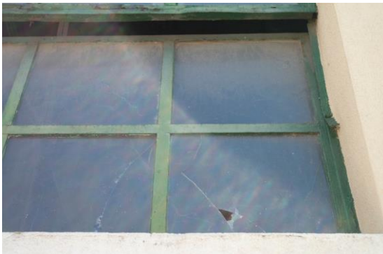
F 18 - Vidros partidos Oxidação de elementos metálicos Fonte: Autora (2017)
