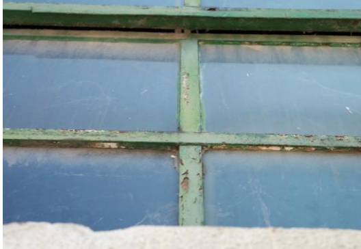
F 14 - Oxidação de elementos metálicos não estruturais Fonte: Autora (2017)
