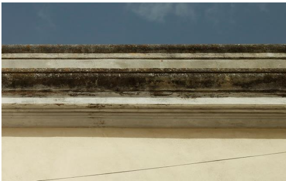
F 1 - Cornija com sinais evidentes de degradação Fonte: Autora (2017)
