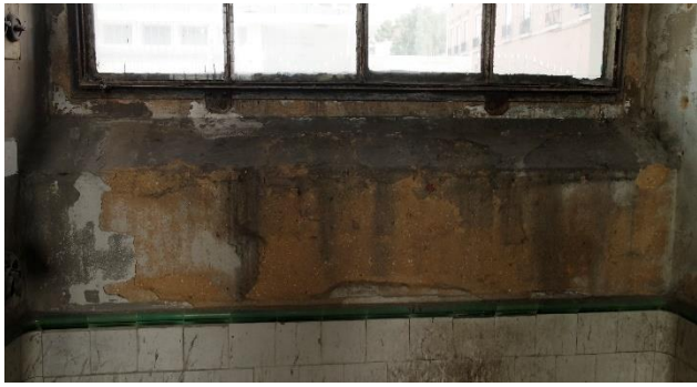
I 10 - Desagregação do revestimento da parede Manchas de humidade Oxidação de elementos metálicos não estruturais Fonte: Autora (2017)
