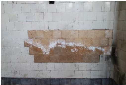
I 5 -Destacamento do revestimento azulejo Fonte: Autora (2017)
