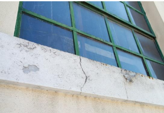
F 13 - Empolamento de pintura na cantaria Fendilhação na cantaria Fonte: Autora (2017)
