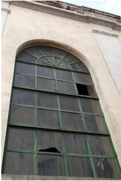
F 7 - Vidros partidos e elementos metálicos oxidados Fonte: Autora (2017)
