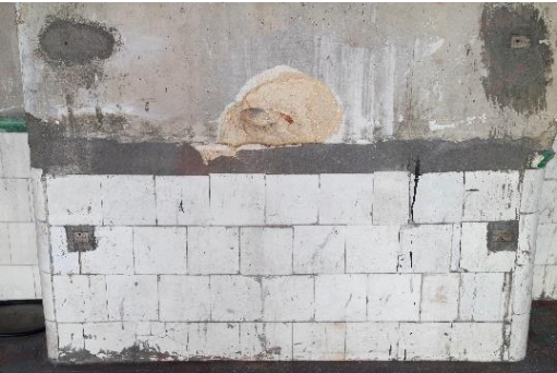
I 1 - Desagregação do revestimento da parede Destacamento de azulejos Fendilhação vertical Fonte: Autora (2017)
