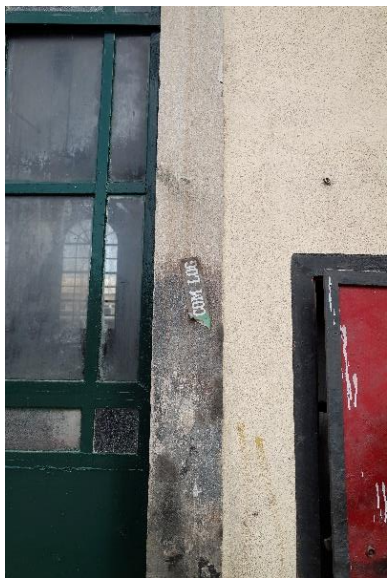
F 5 - Eflorescência na cantaria (ombreira) Fonte: Autora (2017)
