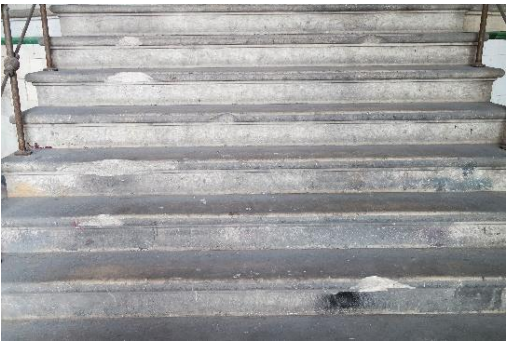
I 2 - Escada revestida a pedra fraturada e com desgaste Fonte: Autora (2017)
