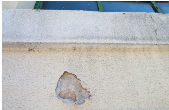
F 17 - Destacamento do revestimento de parede Fonte: Autora (2017)
