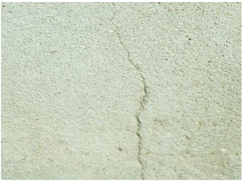
F 4 - Fissura vertical em reboco exterior de parede Fonte: Autora (2017)
