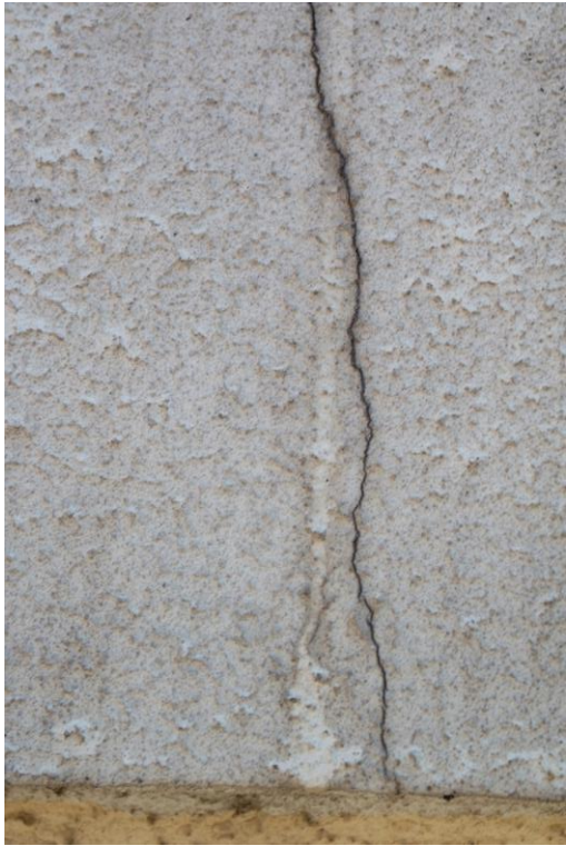
F 11 - Fendilhação vertical estrutural Fonte: Autora (2017)
