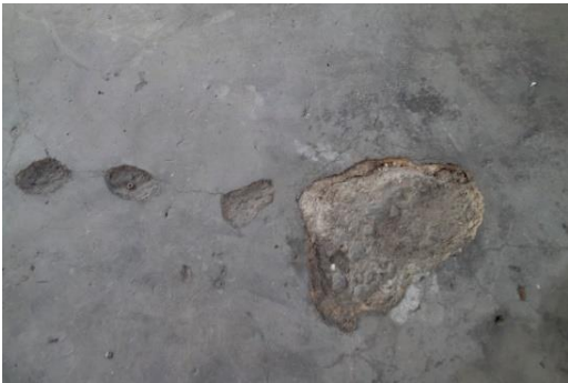
I 4 - Pavimento fraturado e com desgaste Fonte: Autora (2017)
