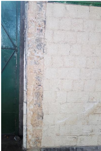
I 13 - Destacamento do revestimento da parede Destacamento de azulejos Fonte: Autora (2017)
