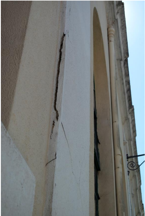
F 12 - Fendilhação vertical em fachada, aparentando ser estrutural Fonte: Autora (2017)
