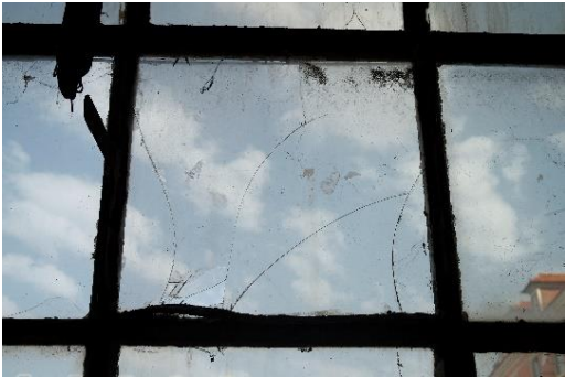
I 3 - Vidros partidos Oxidação de elementos metálicos não estruturais Fonte: Autora (2017)
