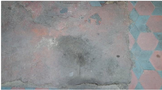
I 9 - Pavimento mosaico hidráulico fraturado e com desgaste provocado pela utilização Fonte: Autora (2017)
