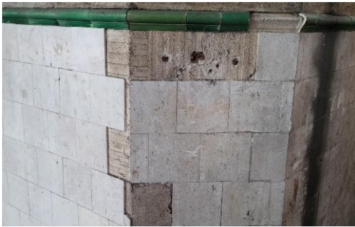
I 7 - Destacamento de azulejos Vestígios de humidade Fonte: Autora (2017)
