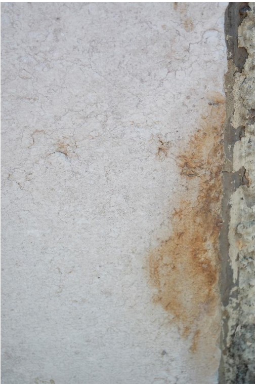
F 9 - Eflorescências e destacamento de pintura Fonte: Autora (2017)
