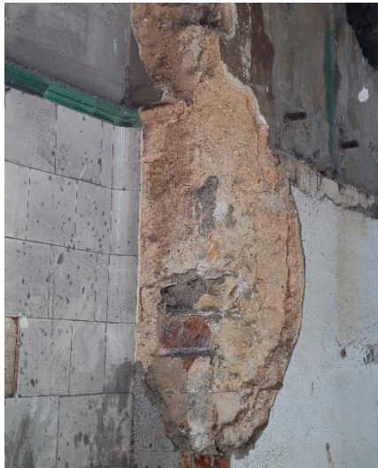
I 12 - Parede fraturada e destacamento de azulejos Fonte: Autora (2017)
