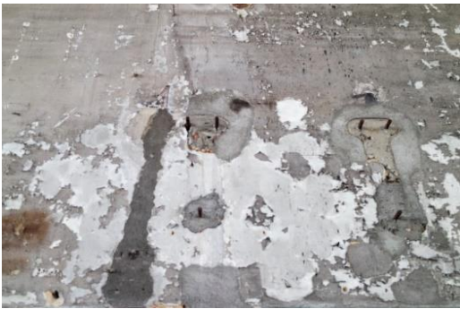
I 6 - Empolamento da pintura e eflorescências Fonte: Autora (2017)
