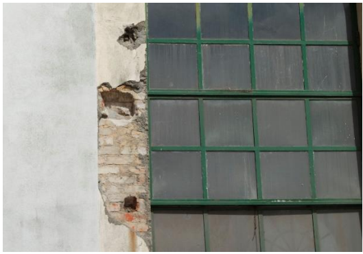
F 2 - Desagregação do revestimento da parede Fonte: Autora (2017)
