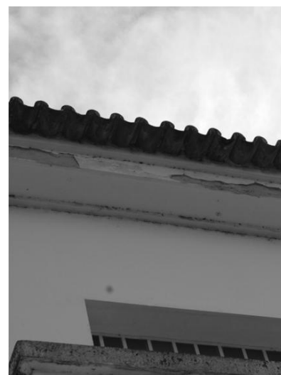
Fig. 64 – Degradação da fachada
