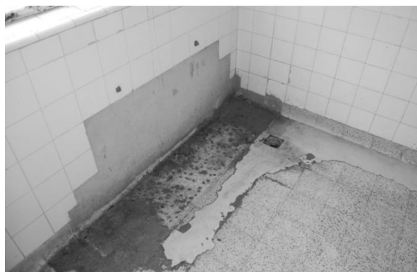
Fig. 44 – Desgaste no pavimento
