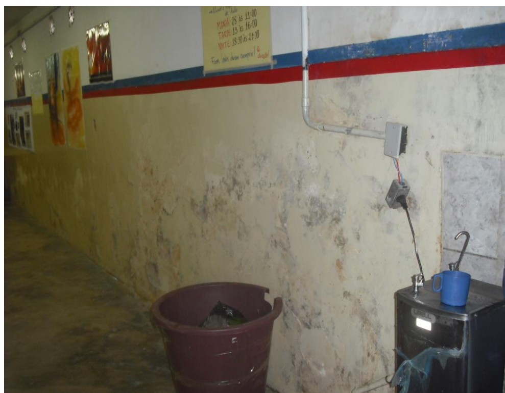
Foto 2 – Infiltração na parede do corredor central da escola e exposição da fiação elétrica
