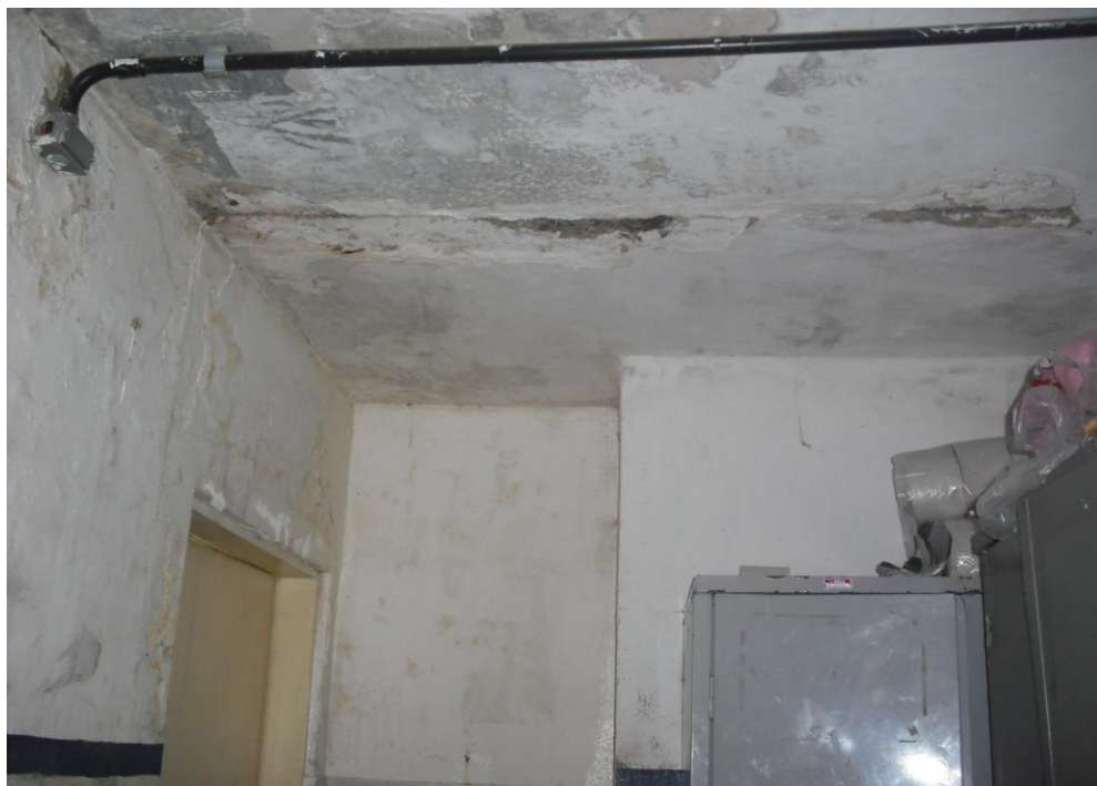
Foto 1 – Infiltração no teto do corredor central da escola
