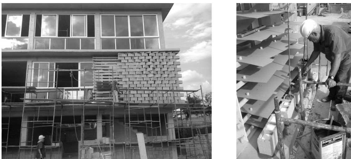
Figura 8 - Montagem da fachada com apoio de guias de papelão. Créditos; Rodrigo Chust
