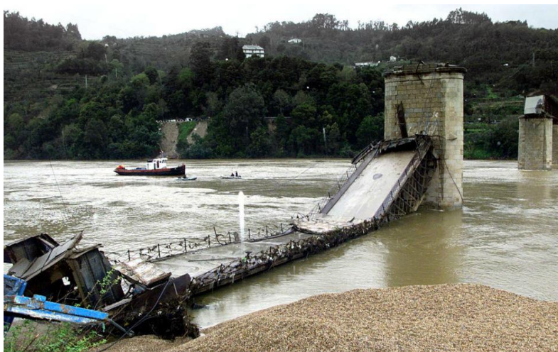
Figura 2.1 - Colapso da ponte de Entre-os-Rios (Fonte: Jornal Económico, 2018)
