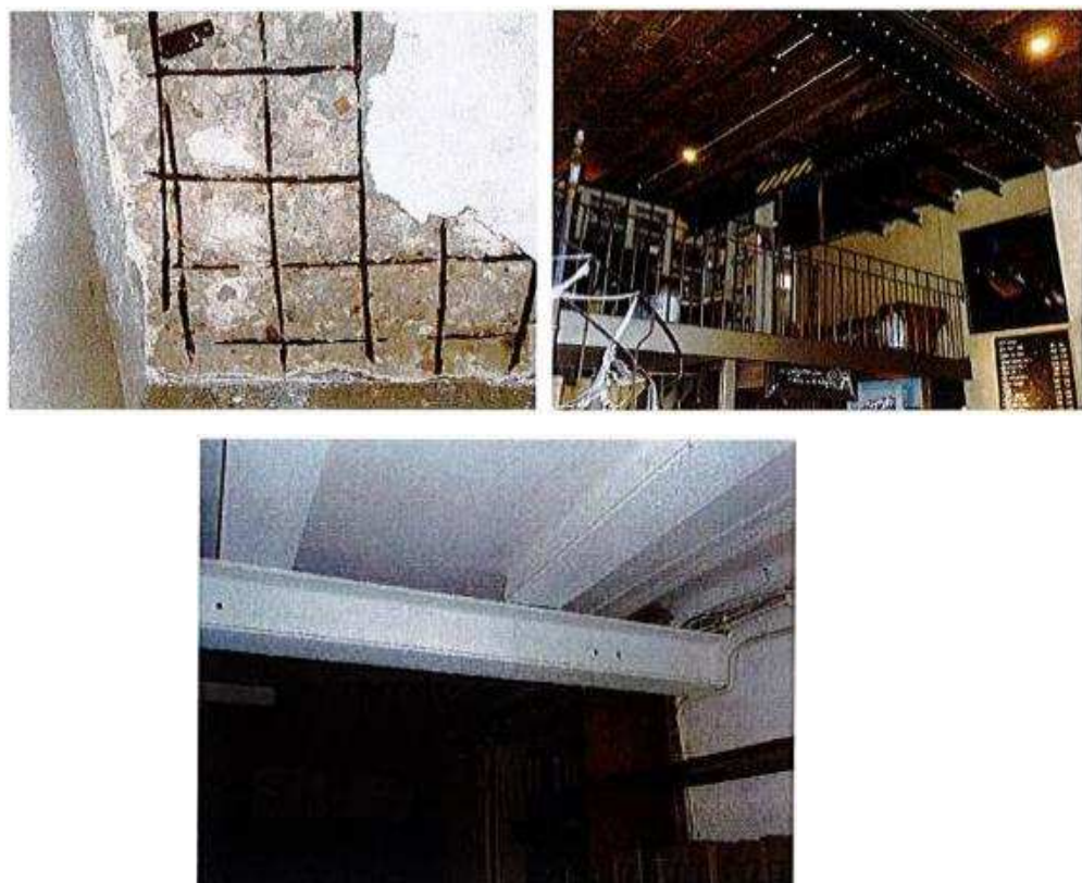
Figura 77 – Laje de betão corroída, vigas simples e rebitadas, alteração estrutural com viga metálica simples,
