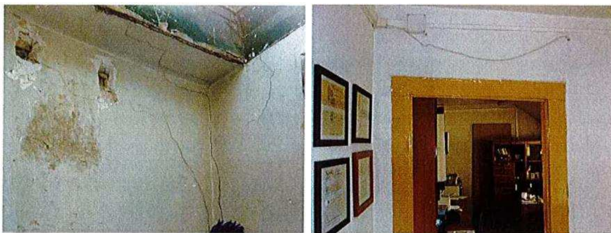
Figura 83 – Fendilhação – imagens do autor
