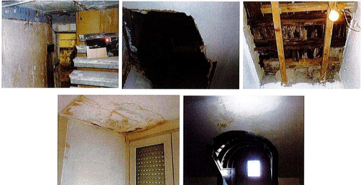
Figura 78 – Danos no edifício,
