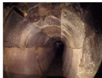
Coletor oval em saiméis - Rua das Portas de Santo Antão; Fotografia Nuno Alexandre; Arquivo Departamento de Saneamento; Câmara Municipal de Lisboa.
