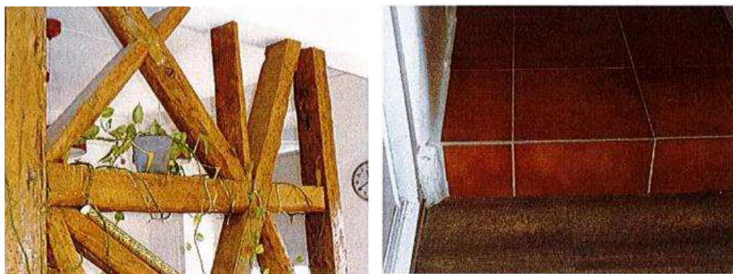
Figura 81 – Alterações com efeitos sobre a estrutura – imagens do autor
