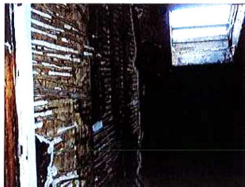
Figura 79 – Danos por ação do fogo
