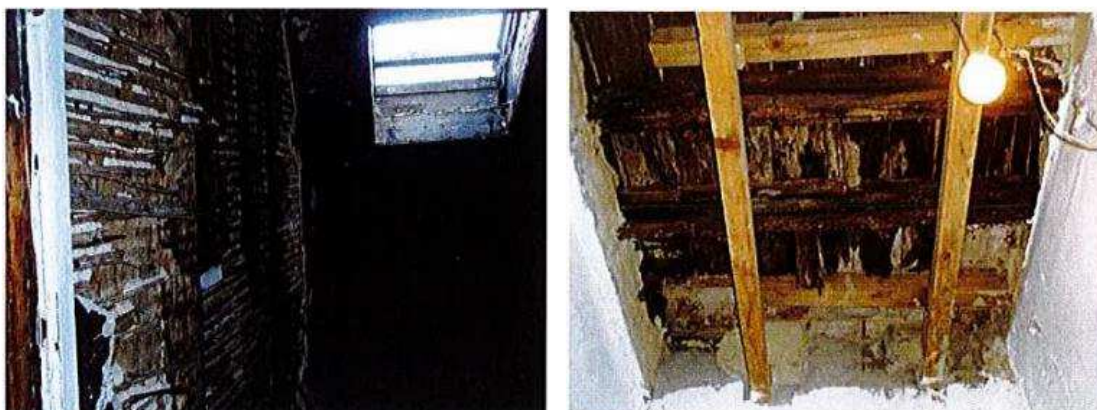
Figura 84 – Carbonização e podridão da madeira - imagens do autor
