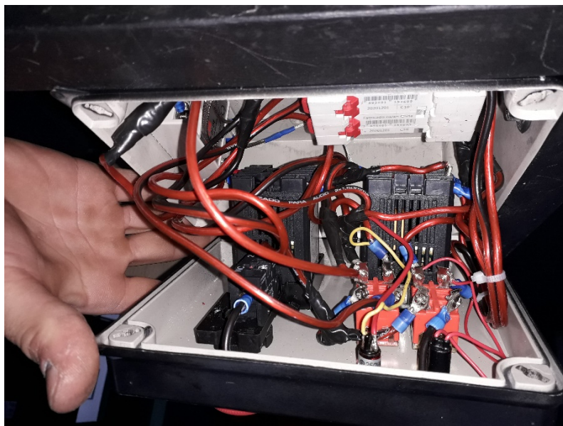
Figura 20 - Parte interna da caixa controladora da extrusora
